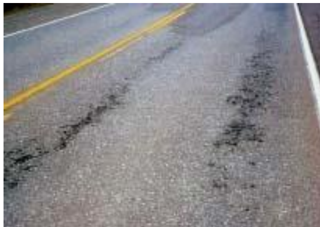
Figure III.19 : Désenrobage et arrachement dans les couches de chaussées
