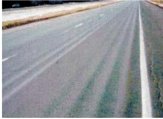
Figure III.17 : Ornière à faible rayon dans les couches de chaussées
