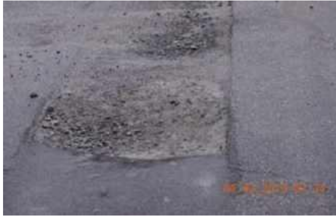
Figure III.14 : Affaissement de chaussée suivi d'une dégradation du revêtement
