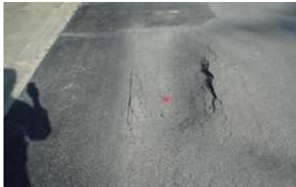
Figure III.13 : affaissement des chaussées
