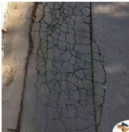
Figure III.15 : Tassement des couches de chaussées
