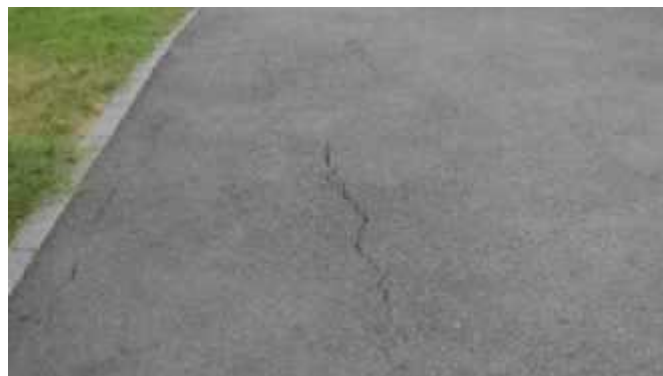
Figure III.12 : apparition des fissures longitudinales sur les routes
