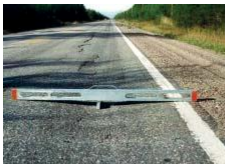
Figure III.18 : Ornière à grand rayon dans les couches de chaussées.
