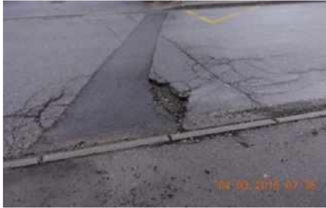
Figure III.16 : - décohésion du sol de part et d'autre de la tranchée un faïençage revêtement
