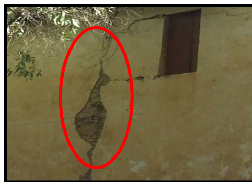
Photo 4.31 : Fissurations des murs
