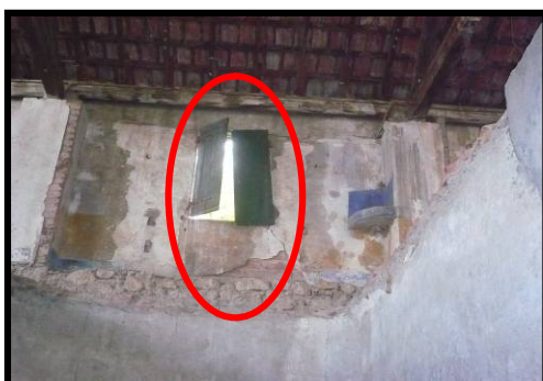
Photo 4.34: Les ouvertures souffrent de la dégradation de la boiserie
