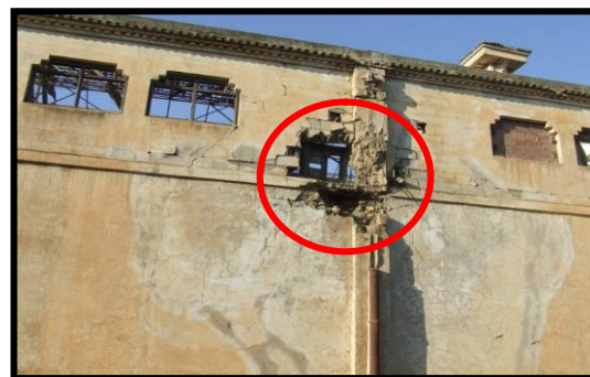
Photo 4.108: Altération des éléments porteurs
