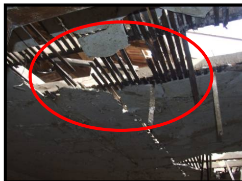
Photo 4.25: Etat du faux plafond
