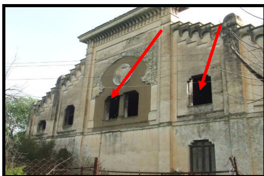
Photo 4.81 : Ouvertures brûlées ou altérées
