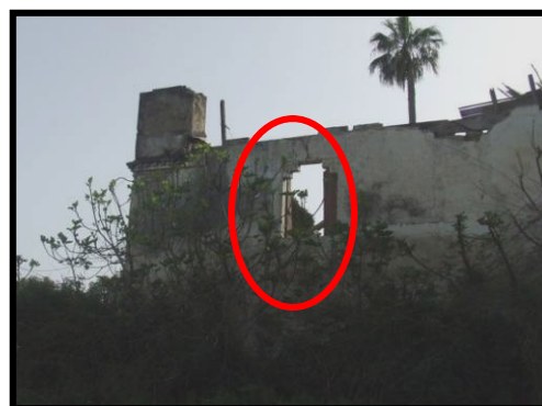
Photo 4.35: Les ouvertures souffrent de la dégradation de la boiserie
