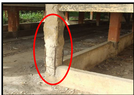
Photo 4.9 : Corrosion du béton et des armatures
