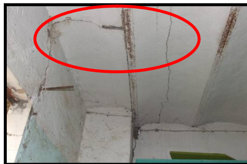
Photo 4.118: Fissures de la dalle en voutain
