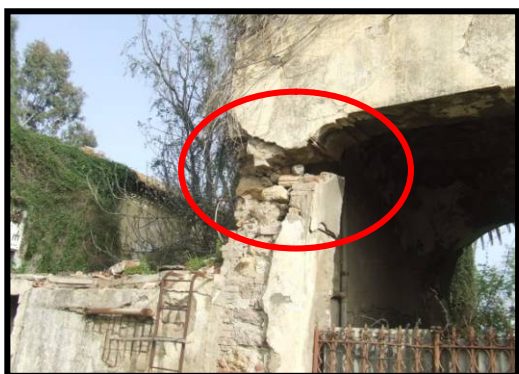
Photo 4.98: Désolidarisation des composantes du mur porteur
