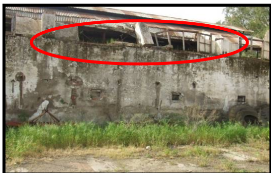
Photo 4.55: Les murs tombent en ruine
