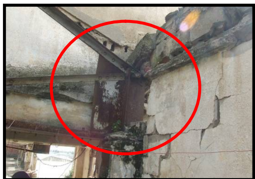
Photo 4.74: Dégradation du support des fermes de la cave coopérative
