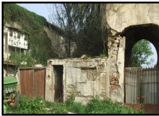
Photo 4.42: Porte et portail en mauvais état
