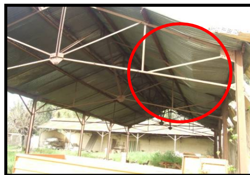
Photo 4.103: Déformation de la toiture
