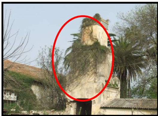
Photo 4.41: Château d'eau regagné par la végétation
