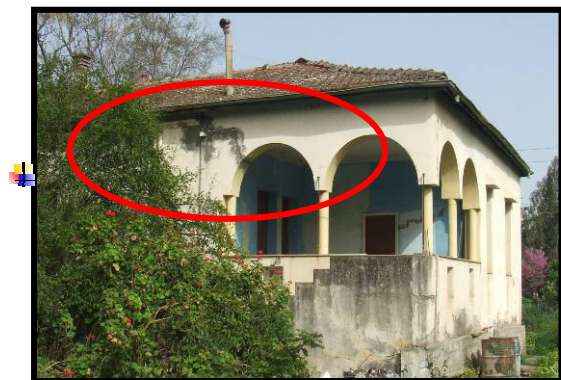
Photo 4.85 : La fissuration des murs
