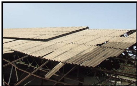
Photo 4.111: Altération de la toiture
