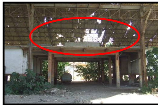
Photo 4.106 : Altération de la toiture
