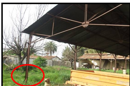
Photo 4.61: déformation du pied métallique
