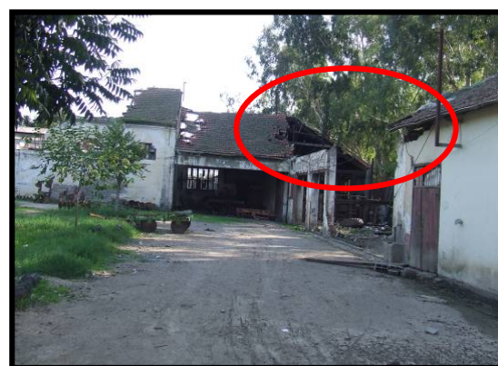
Photo 4. 5: Dégradation de la toiture de la forge et du garage mécanique
