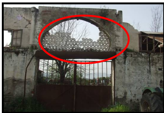
Photo 4.59 : Traitement décoratif en plâtre endommagé
