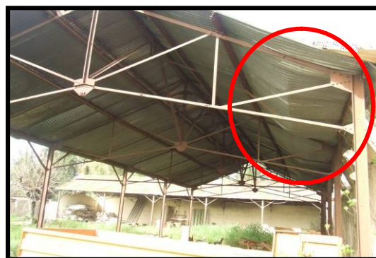
Photo 4.62 : déformation de la toiture par le poids du mur de l'écurie
