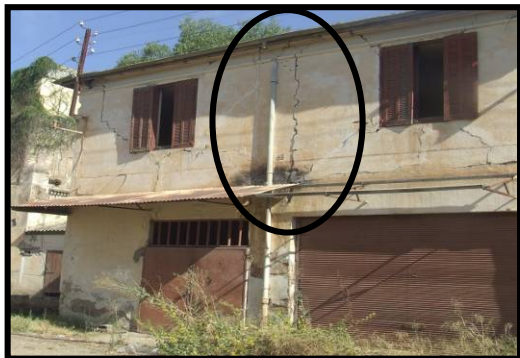
Photo 4.116 : Fissures au niveau de la façade
