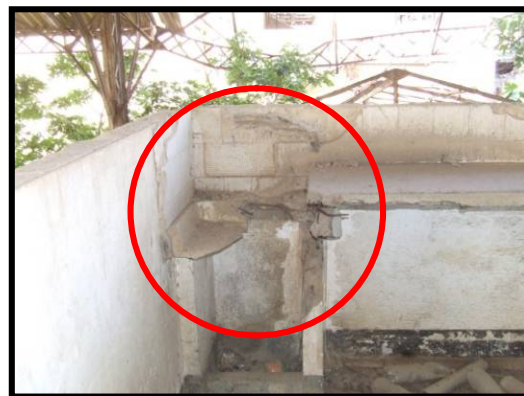
Photo 4.73 : Support de travail altéré
