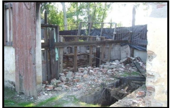
Photo 4.48: Les murs délabrés
