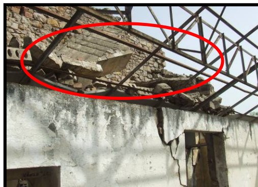
Photo 4.75: Dégradation des murs de la cave coopérative
