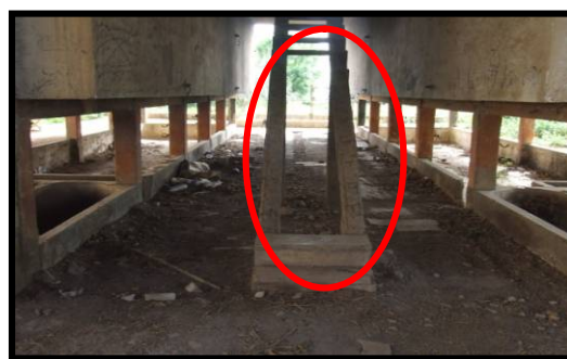
Photo 4.71: Marches des escaliers détruites
