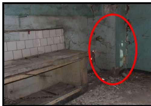
Photo 4.88 : Fissuration verticale le long des murs et de la structure
