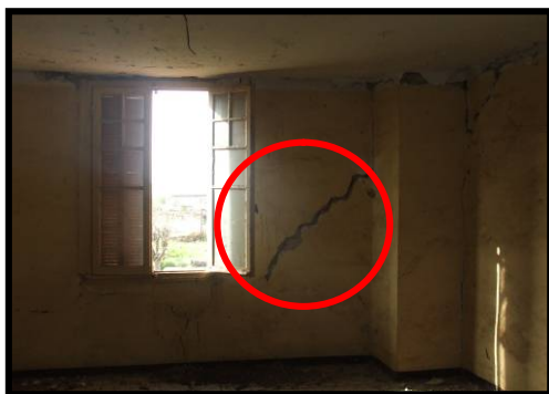
Photo 4.87: Fissuration oblique des murs
