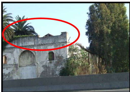
Photo 4.32: Effondrement de la toiture suite aux pluies
