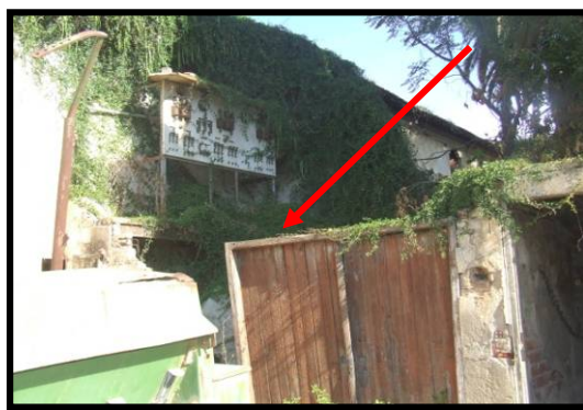
Photo 4.99 : Eroulement de la dalle
