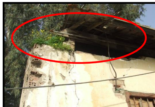
Photo 4.44: mur délabré et fissuré de plus regagné par la végétation
