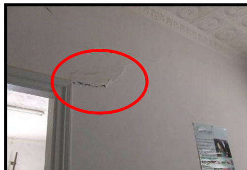
Photo 4.94 : Fissure diagonale superficielle
