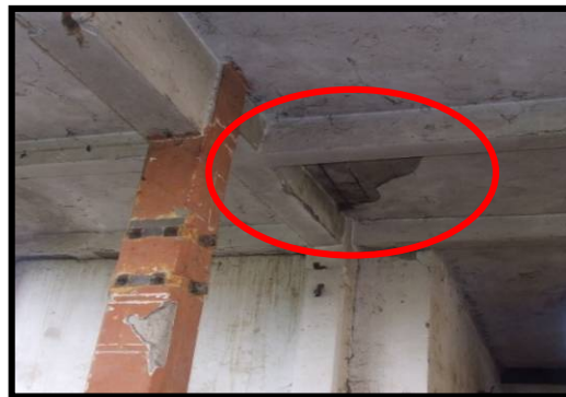
Photo 4.64: Dégradation de la dalle des cuves
