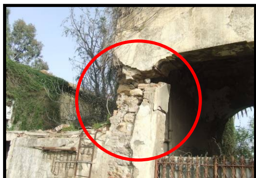
Photo 4.37 : La rupture d'une partie du mur
