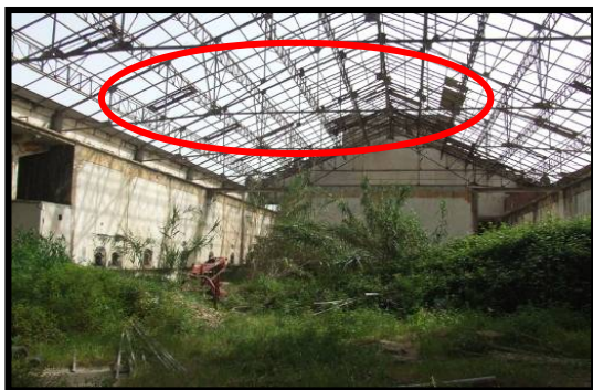
Photo 4.79 : Détérioration de la toiture
