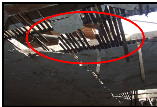
Photo 4.90: Altération de la toiture et du faux plafond
