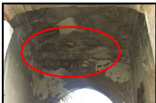
Photo 4.39 : Dégradation de la dalle du château d'eau
