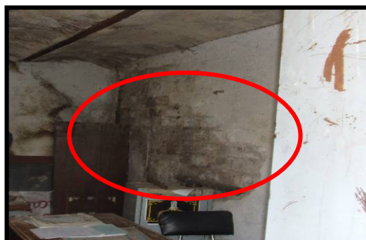
Photo 4.38 : Détérioration du revêtement intérieur à cause de l'humidité
