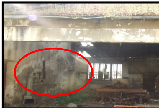
Photo 4. 52: Les murs sont altérés
