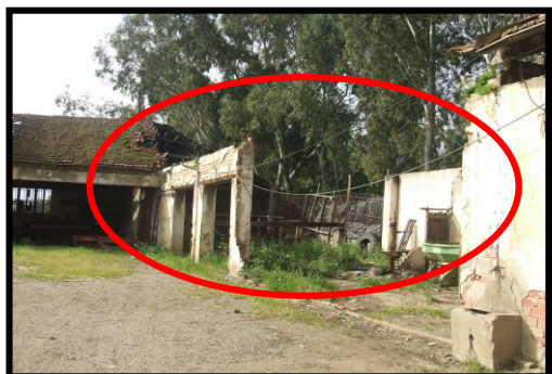
Photo 4.6 : Destruction des murs
