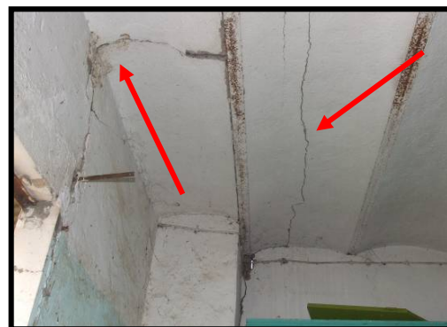
Photo 4.8 : Fissures des dalles et murs
