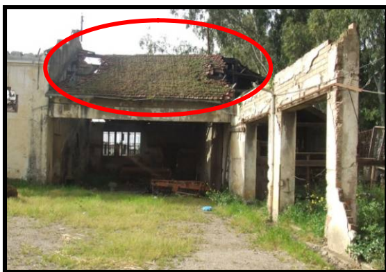
Photo 4.53 : toiture et gouttière détériorées
