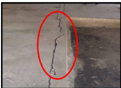
Photo 4.65: la dalle des cuves fissurée
