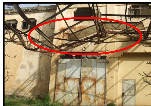
Photo 4.80 : Détérioration de la toiture de l'entrée
