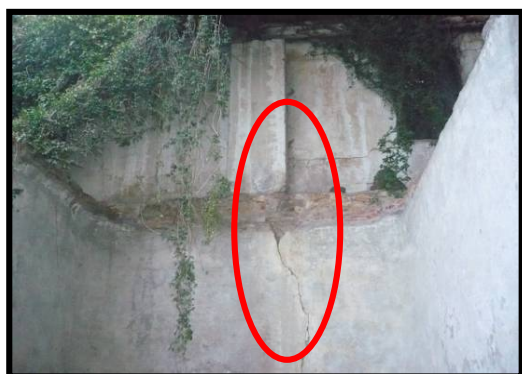
Photo 4.95 : Fissure au niveau du changement du système porteur
