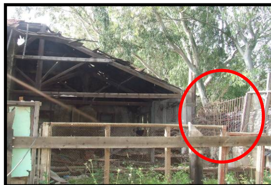
Photo 4.51: Les fenêtres sont délabrées
