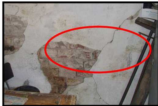
Photo 4.36 : Fissuration et détérioration du revêtement intérieur
