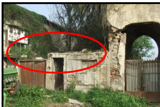
Photo 4.40 : Ecoulement de la dalle de la partie Ouest
