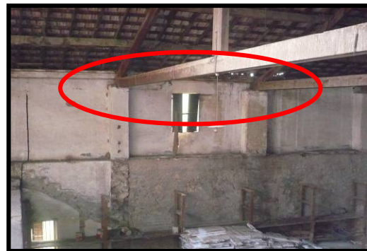
Photo 4.29 : Ferme en bois posée sur des poteaux et encastrée dans les murs
