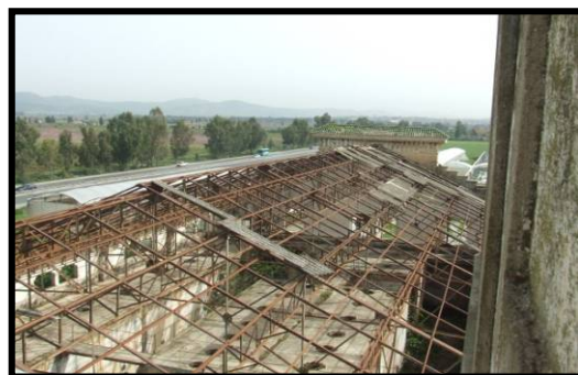
Photo 4.112: Altération de la toiture
