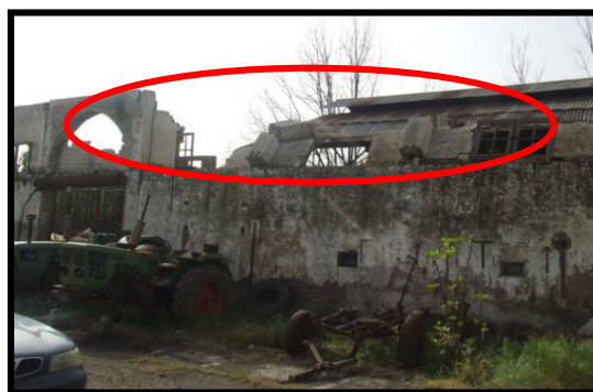
Photo 4.56: Les murs tombent en ruine
