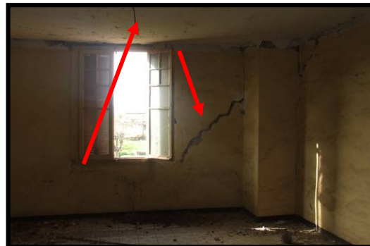
Photo 4.117: Fissures diagonales dans le mur et fléchissement du faux plafond
