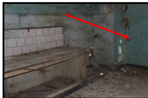
Photo 4.115 : Fissures au niveau des poteaux
