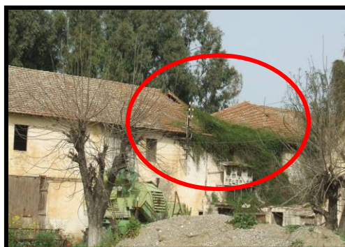
Photo 4.33: Effondrement de la toiture suite aux poids de la végétation
