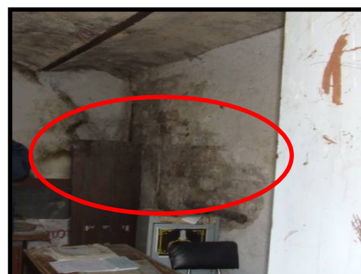
Photo 4.97: Détérioration du revêtement par les moisissures
