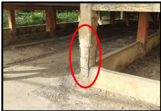
Photo 4.63: Corrosion du béton
