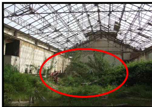
Photo 4.7 : Prolifération de la végétation
