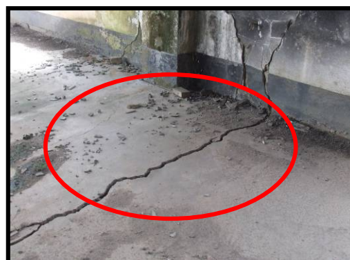
Photo 4.77: Fissuration du plancher des cuves à vin
