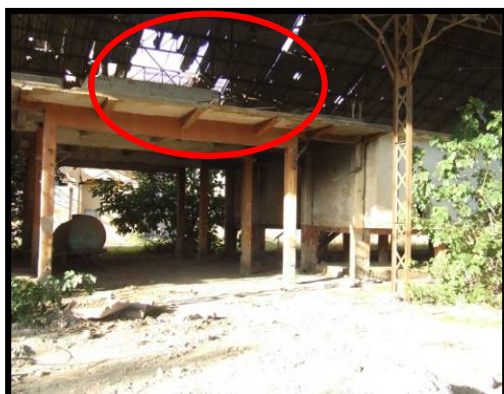
Photo 4.69: Une partie des modules de la toiture souffre de dégradation
