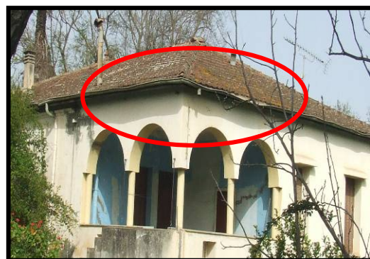
Photo 4.86 : La toiture regagnée par la végétation et dégradation de la gouttière
