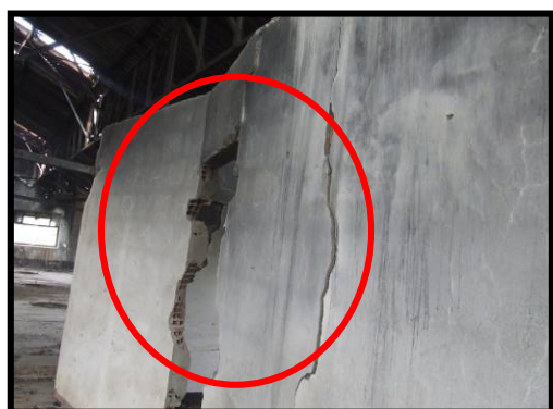
Photo 4.76: Dégradation des murs des bureaux de la C.O.F.L
