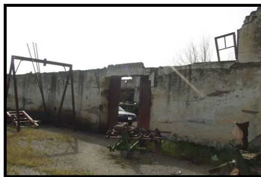
Photo 4.60: Fenêtres et portails endommagées
