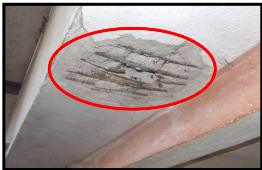
Photo 4.105: Corrosion du béton de la dalle
