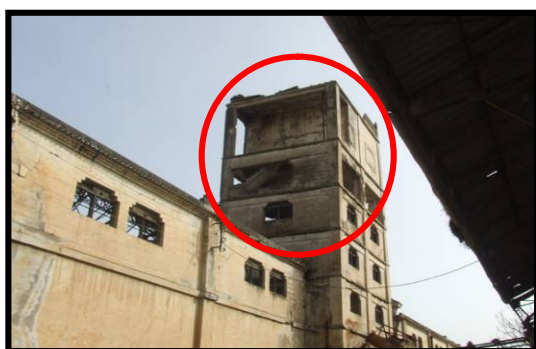
Photo 4.83 : Dégradation des murs de la cage d'escalier
