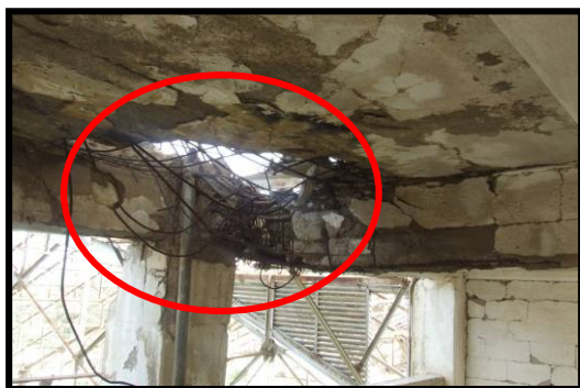
Photo 4.107 : Altération d'éléments porteurs
