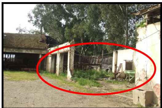
Photo 4.43: les murs du garage détruits
