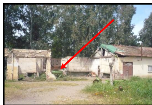
Photo 4.100: Altération de la partie abandonnée
