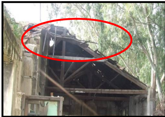
Photo 4.49 : Toiture en mauvaise état
