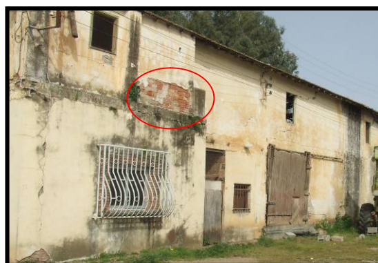
Photo 4.10 : Dégradation des revêtements
