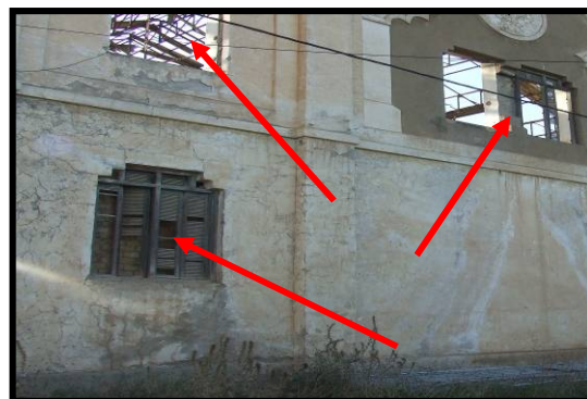
Photo 4.11: Dégradation de la boiserie
