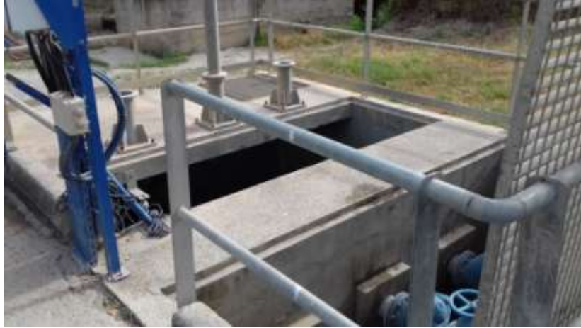
Figure14. Poste de relevage.
