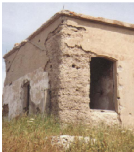
Figure I.4. Dégradation d'un ouvrage soumis au gel dégel
