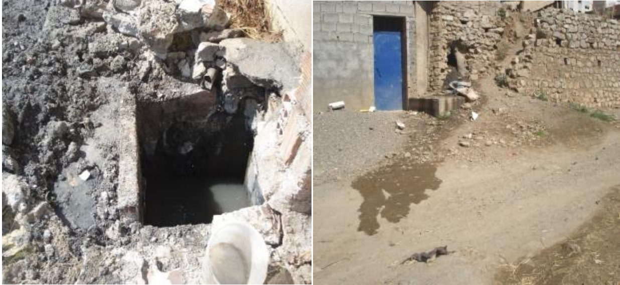
Fig.4.7 : désordres au niveau des réseaux d'assainissement
