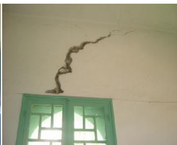
Fig.4.6 : Fissures importantes au niveau des murs
