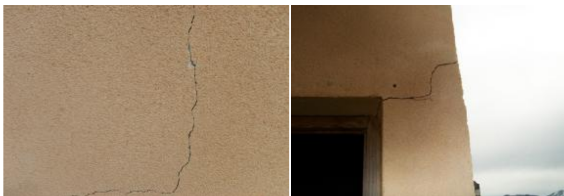
Fig.2-8 : Apparition des fissures sur les constructions.
