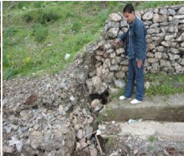
Fig.2-19-Etat du mur (avril 2009).
