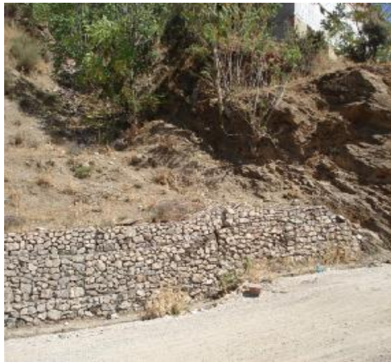
Fig.2-18 : Etat du mur (septembre 2006).
