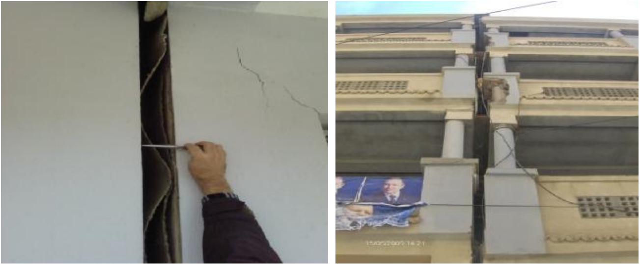
Fig.4.1 : Ouverture des joints entre blocs
