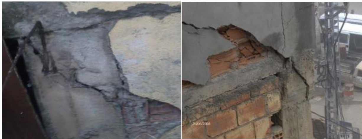
Fig.4.4 : Éclatement des nœuds (Poteau poutre)
