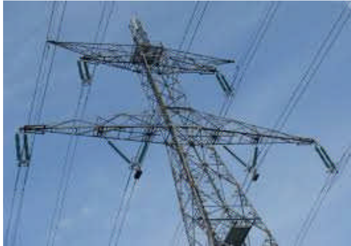
Figure 3.5: lignes électriques soutenues par un pylône avec isolation.
