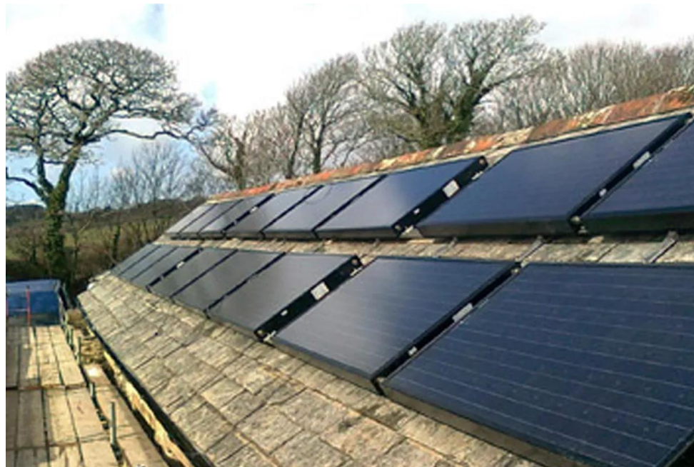
Figure159 : Panneaux photovoltaïques hybrides.
