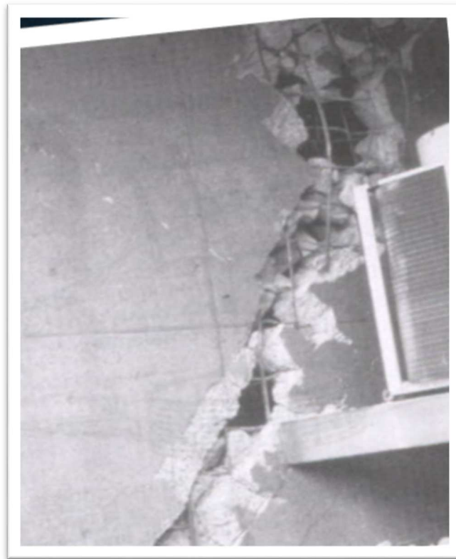
Figure II.26 : Dommage subis par un voile durant le séisme tout en continuant à supporter le poids de son plancher (séisme de Kobé, Japon 1995) [25]
