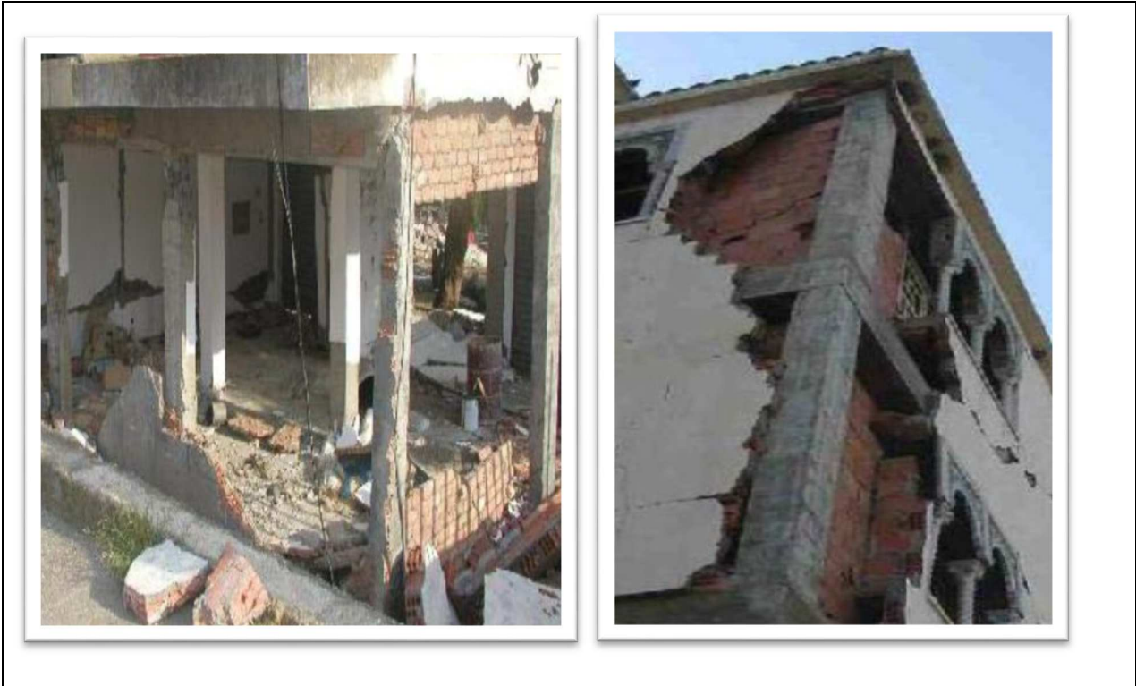
Figure II.21 : Dommages sur les éléments non structuraux
