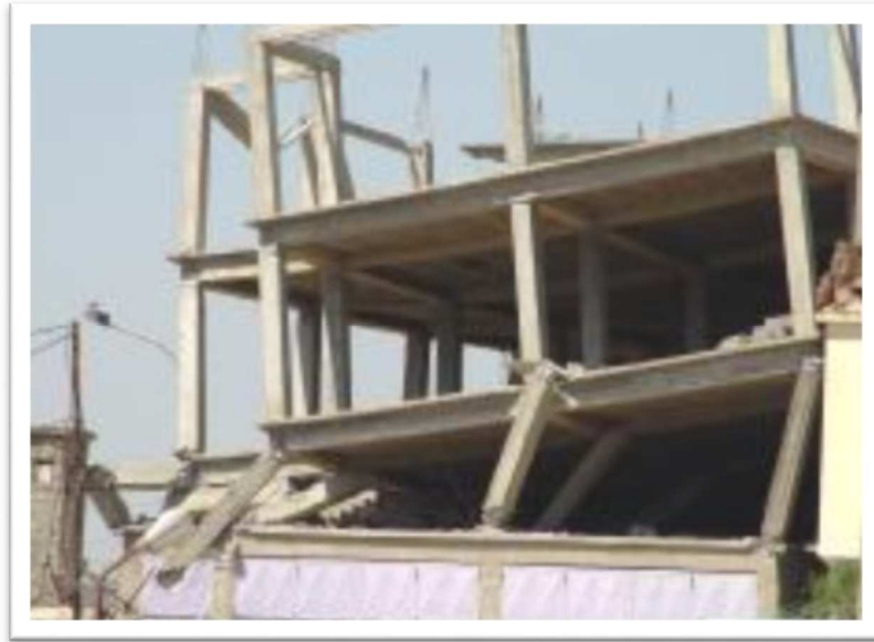
Figure II.22 : Effondrement d'un bâtiment du a des grands déplacements
