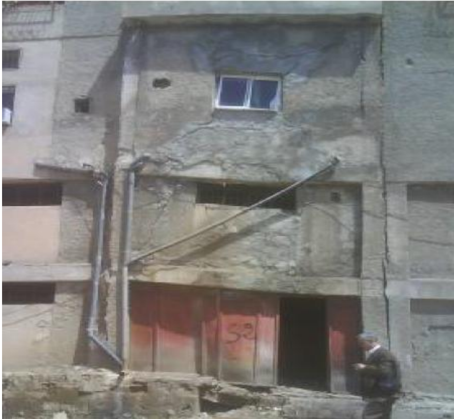
Figure V.29: basculement de l'immeuble APC/CNEP (n° 14 et 15). avril 2009 source: Melle djerbal lynda
