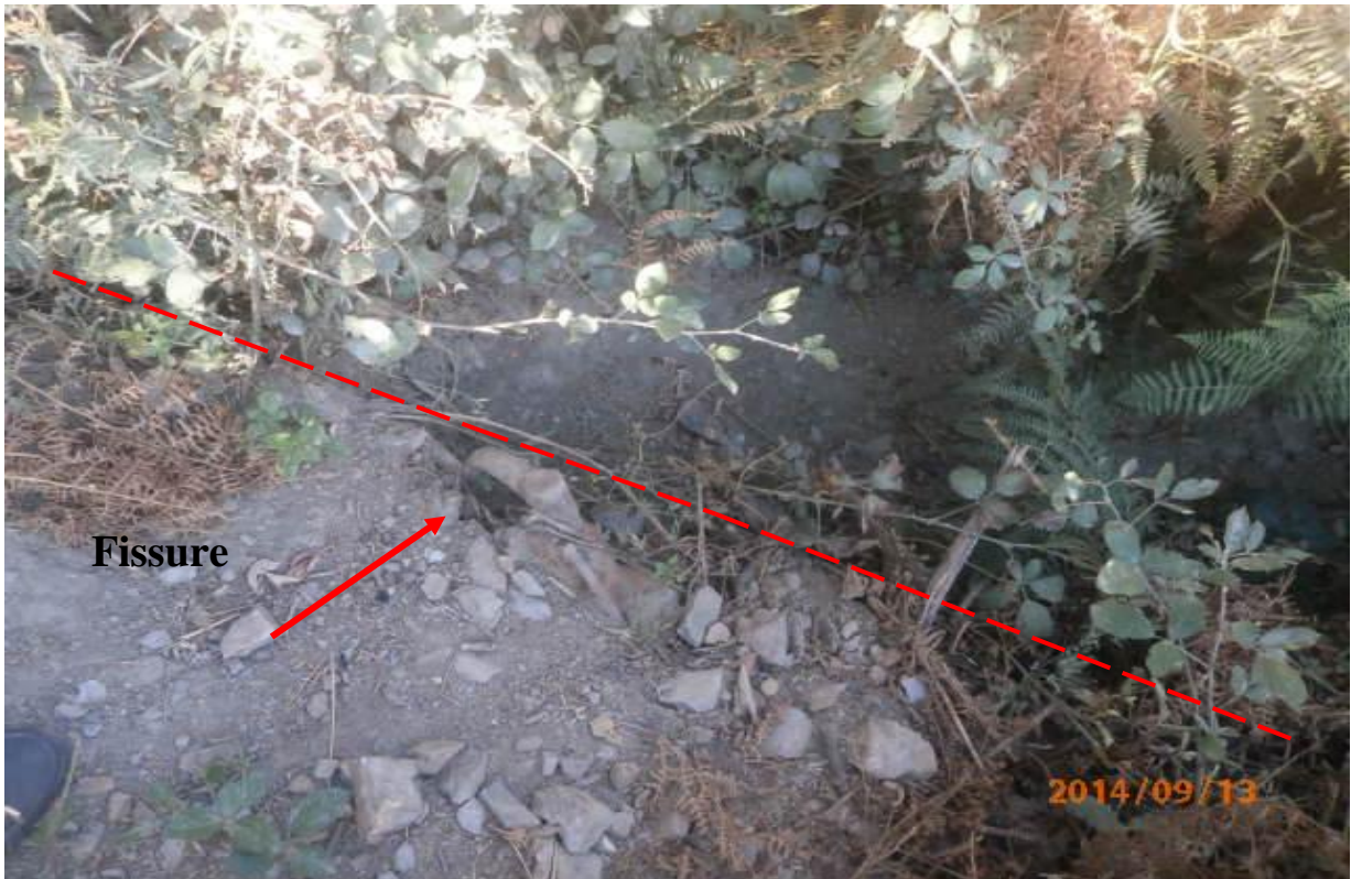
Figure V.9 : fissure dans le sol
