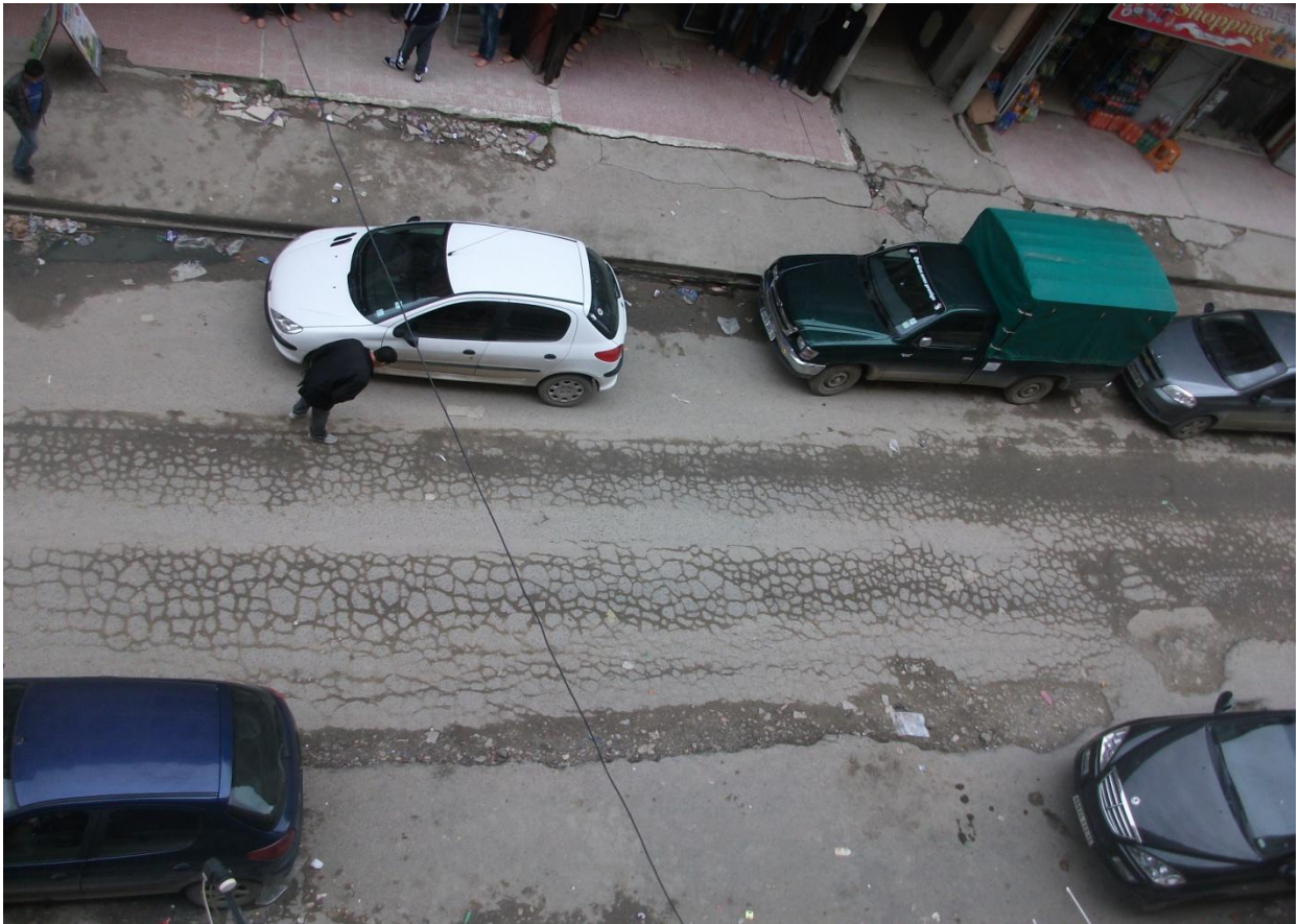
Figure V.13 : dégradation et affaissement de la route
