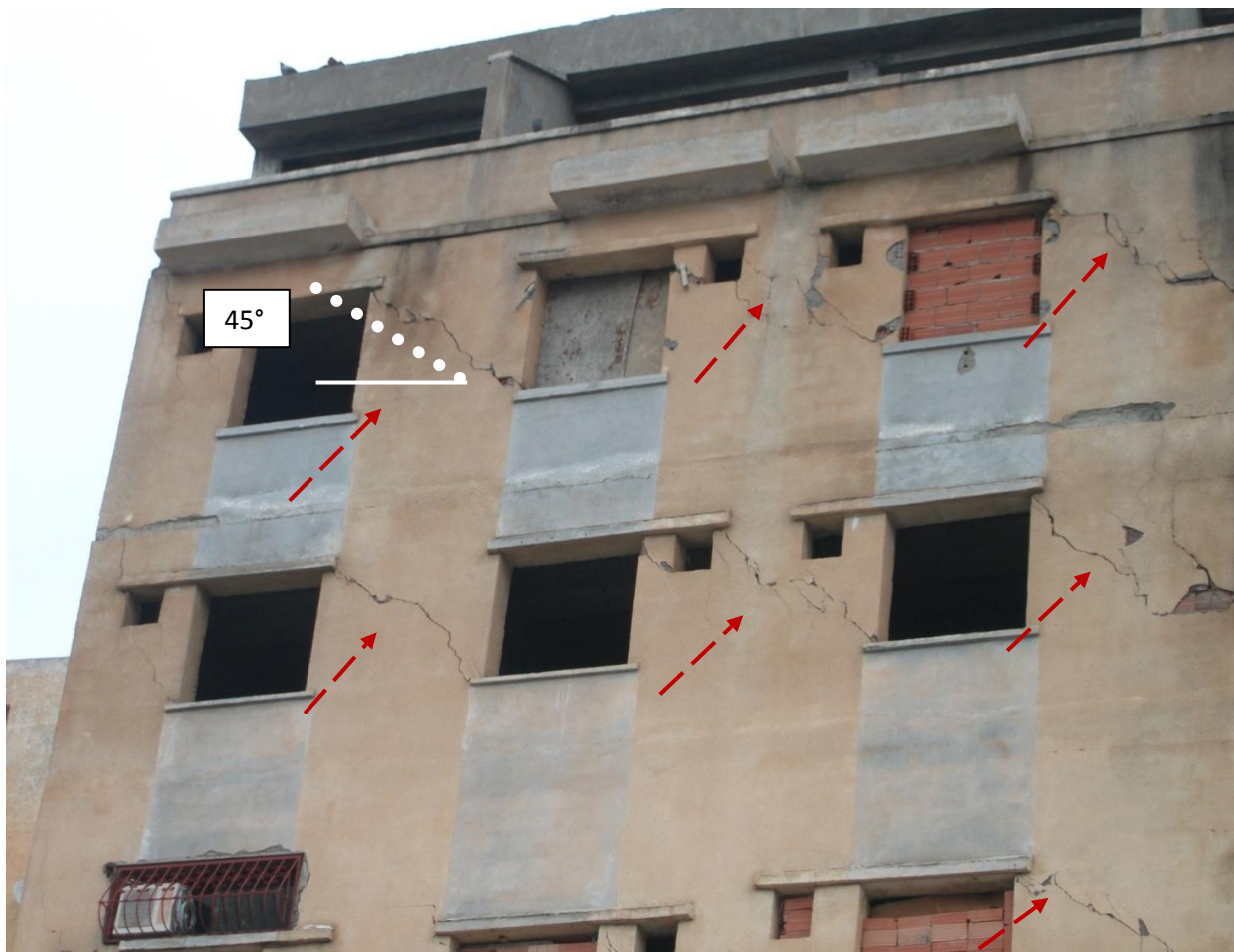
Figure V.25 : Des fissures apparentes au niveau des fenêtres " bâtiment de la cité du marché rue colonel amirouche d'Ain el hammam 2014"
