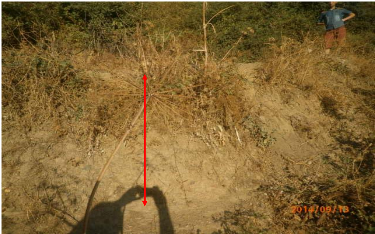
Figure V.4 : affaissement important du terrain en dessous du marché
