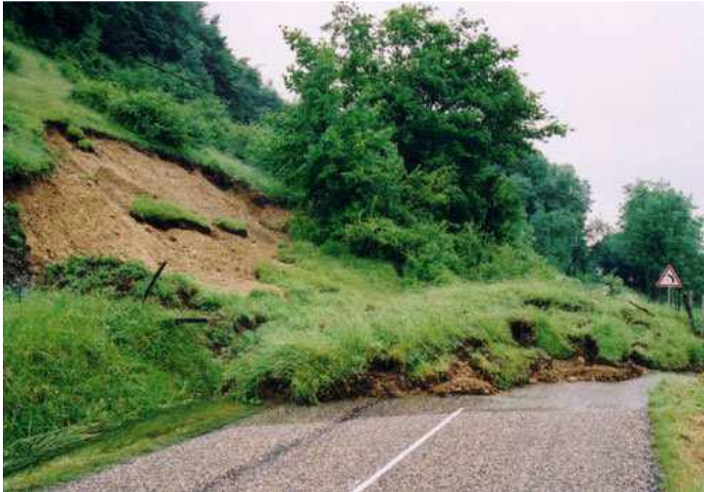
Figure I.18 : Glissement superficiel sur la RD 28 sur la commune de Merlas (Isère) à la suite des fortes précipitations du 6 juin 2002 S. Gominet (IRMa)
