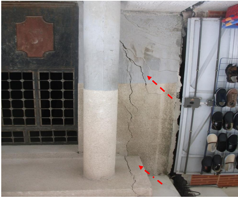
Figure V.18 : Des microfissures verticales au niveau du mur du bâtiment de la cité du marché, mars 2014
