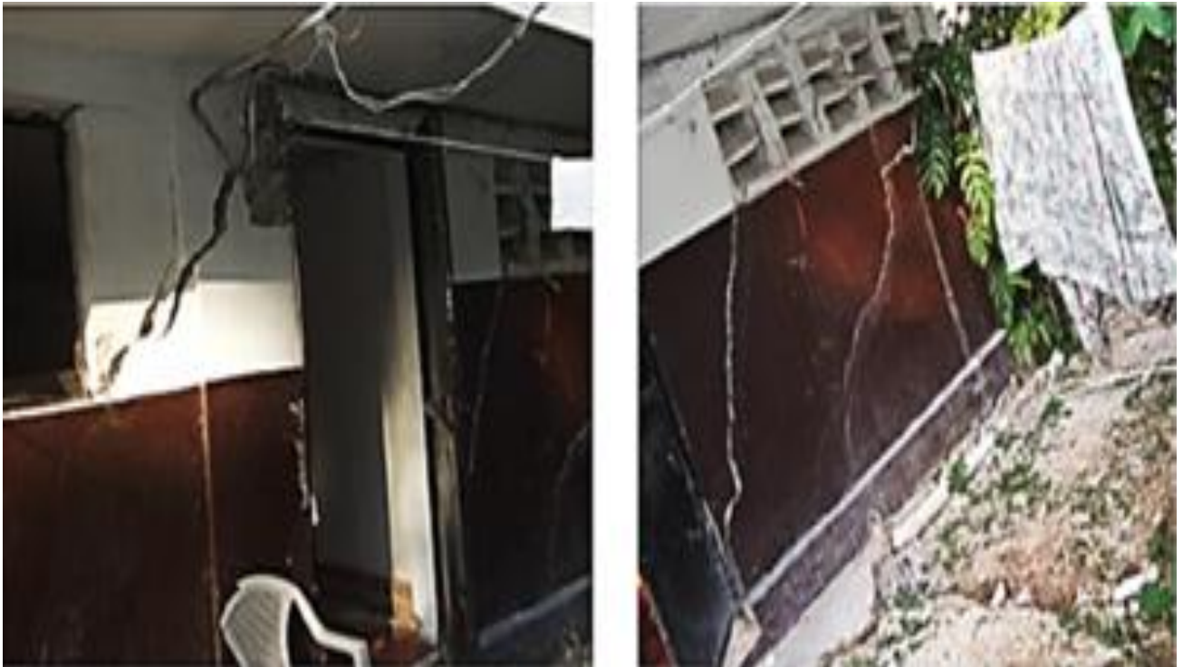
Figure IV.11 : Les fissurations aux niveaux des ouvertures (Le glissement de l'impassé Avalon). Source: Bureau des mines et de l'énergie direction de la géologie et des mines service des mines ; 2008
