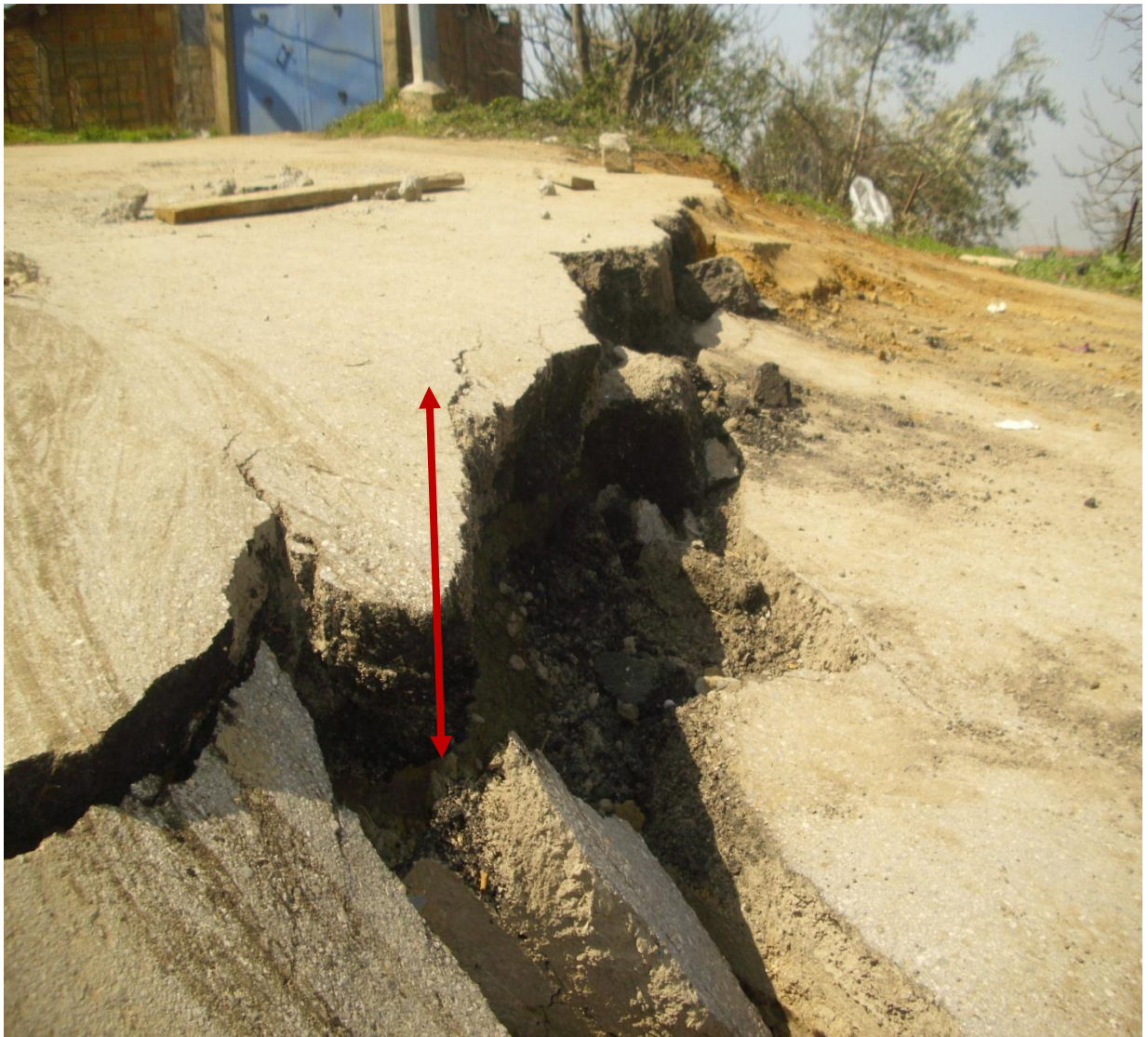
Figure III.6 : Affaissement au niveau de la route à azazga Source: djerbal lynda, mars 2012.
