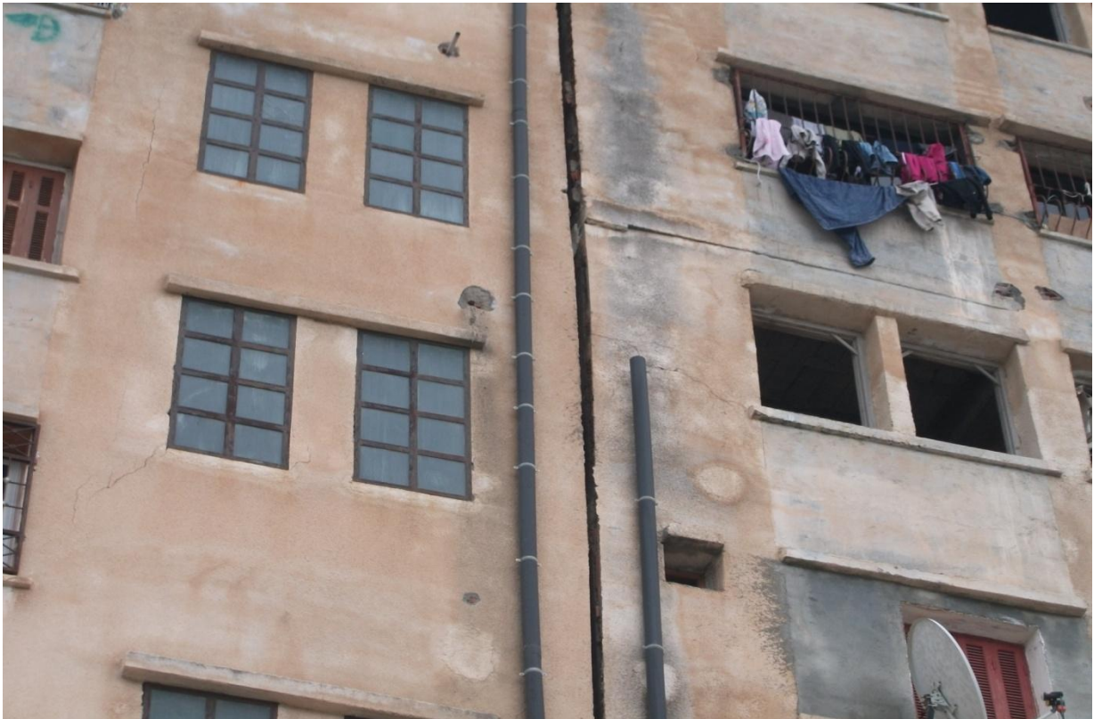
Figure V.22 : écartement du joint de jonction entre les deux bâtiments de la cité du marché, mars 2014
