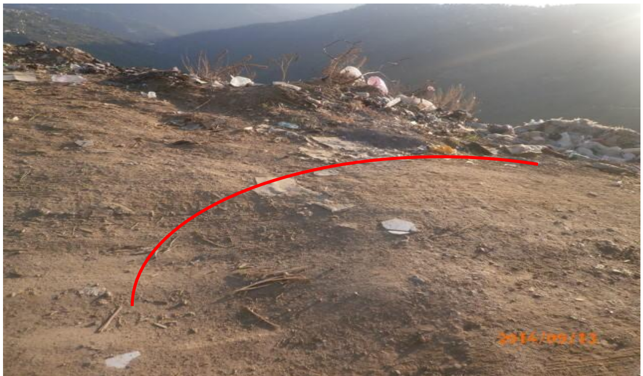
Figure V.7 : bombement remarquable au niveau du terrain du marché
