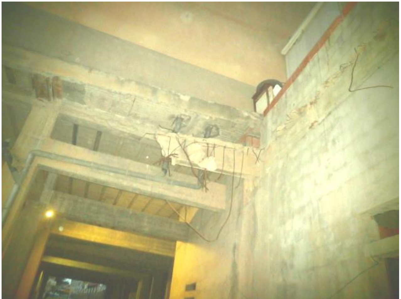
Figure V.27 : Déformation des poutres et apparition des armatures, la façade de derrière de la construction du marché 2014.
