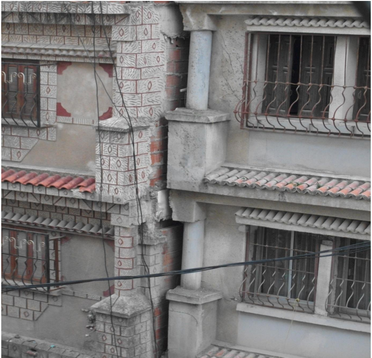
Figure V.24 : rupture de joint de dilatation et basculement du bloc, rue colonel amirouche, mars 2014
