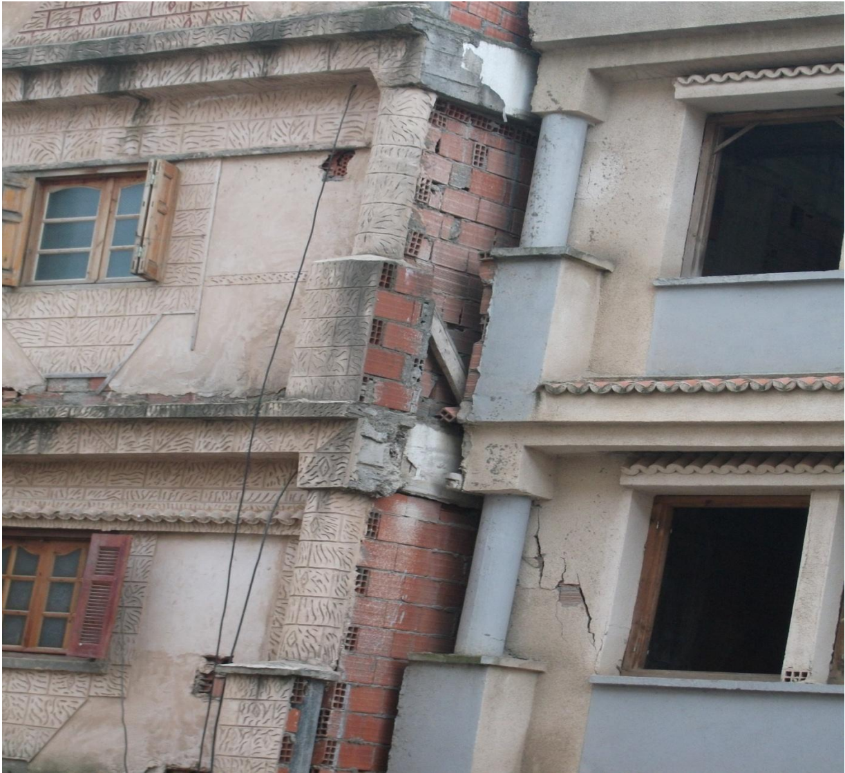
Figure V.23 : "basculement des blocs" rue colonel amirouch 2014
