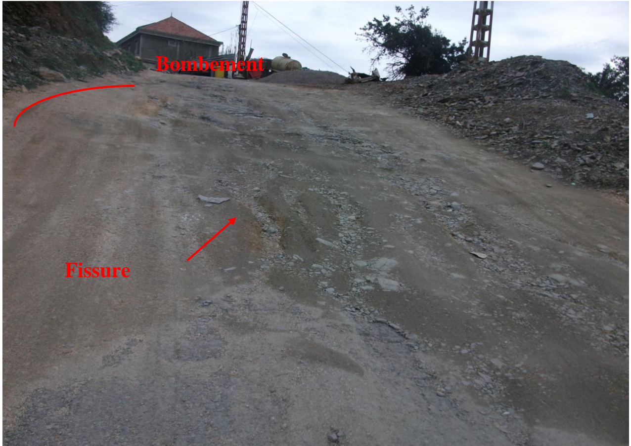
Figure V.14 : dégradation de la chaussée, fissures et bombements route qui mène au village "lazib ait sidi said", mars 2014
