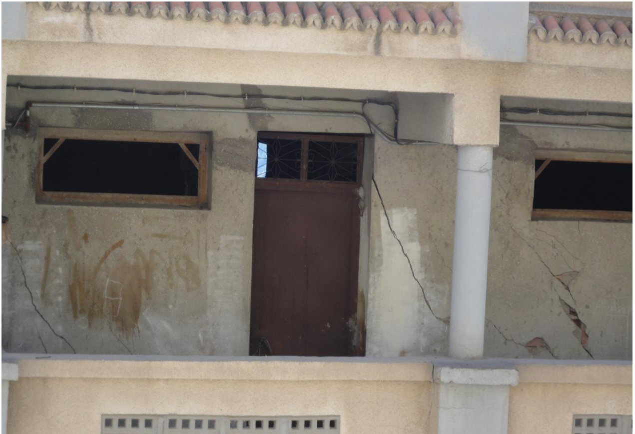
Figure V.26: des fissures au niveau des ouvertures, bâtiment de la citée du marché rue colonel amirouche. mars 2014
