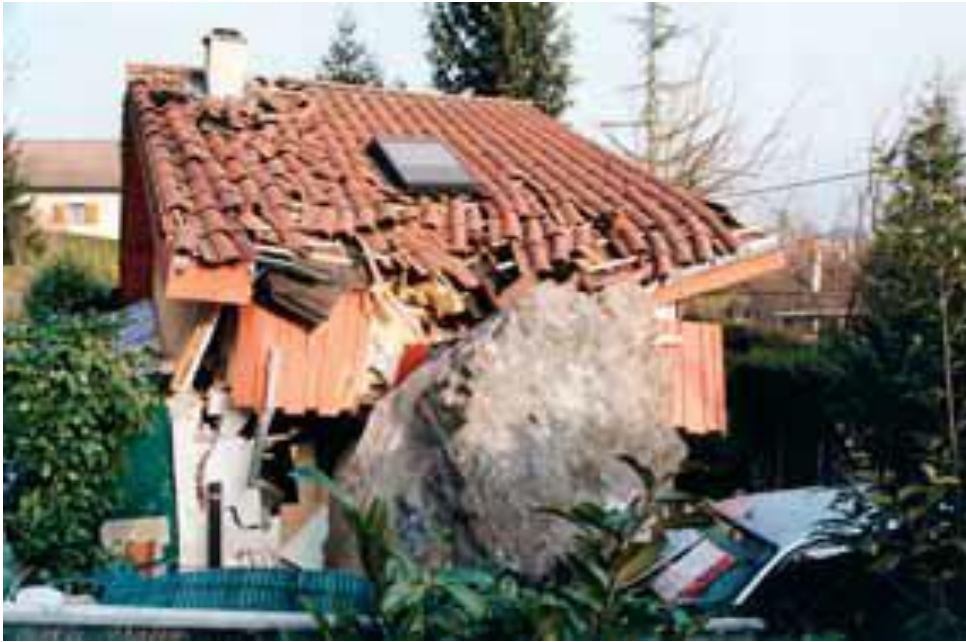
Figure I.13 : Destruction d'une maison à Lumbin (Isère) en janvier 2002 par un bloc provenant de la falaise surplombant la commune (versant Est du massif de la Chartreuse) , S. Gominet (IRMa)
