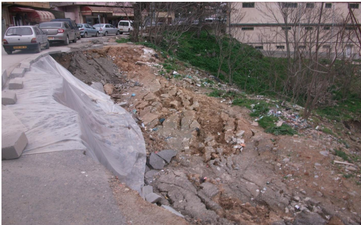
Figure V.5 : affaissement du terrain qui est à coté de la mosquée d'Ain el hammam
