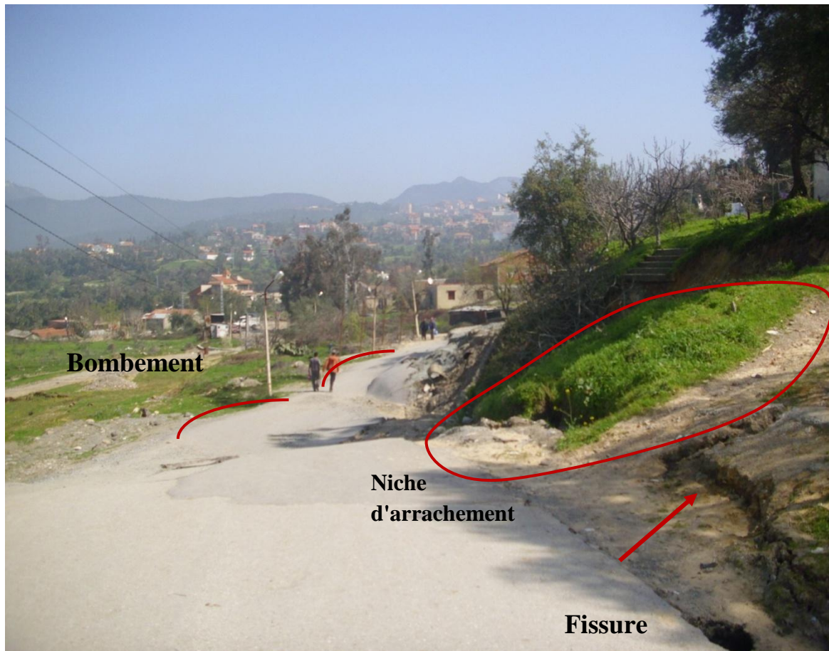
Figure III.2 : dégradation remarquable suite à l'activation d'un glissement de terrain à azazga. Source: djerbal lynda, mars 2012
