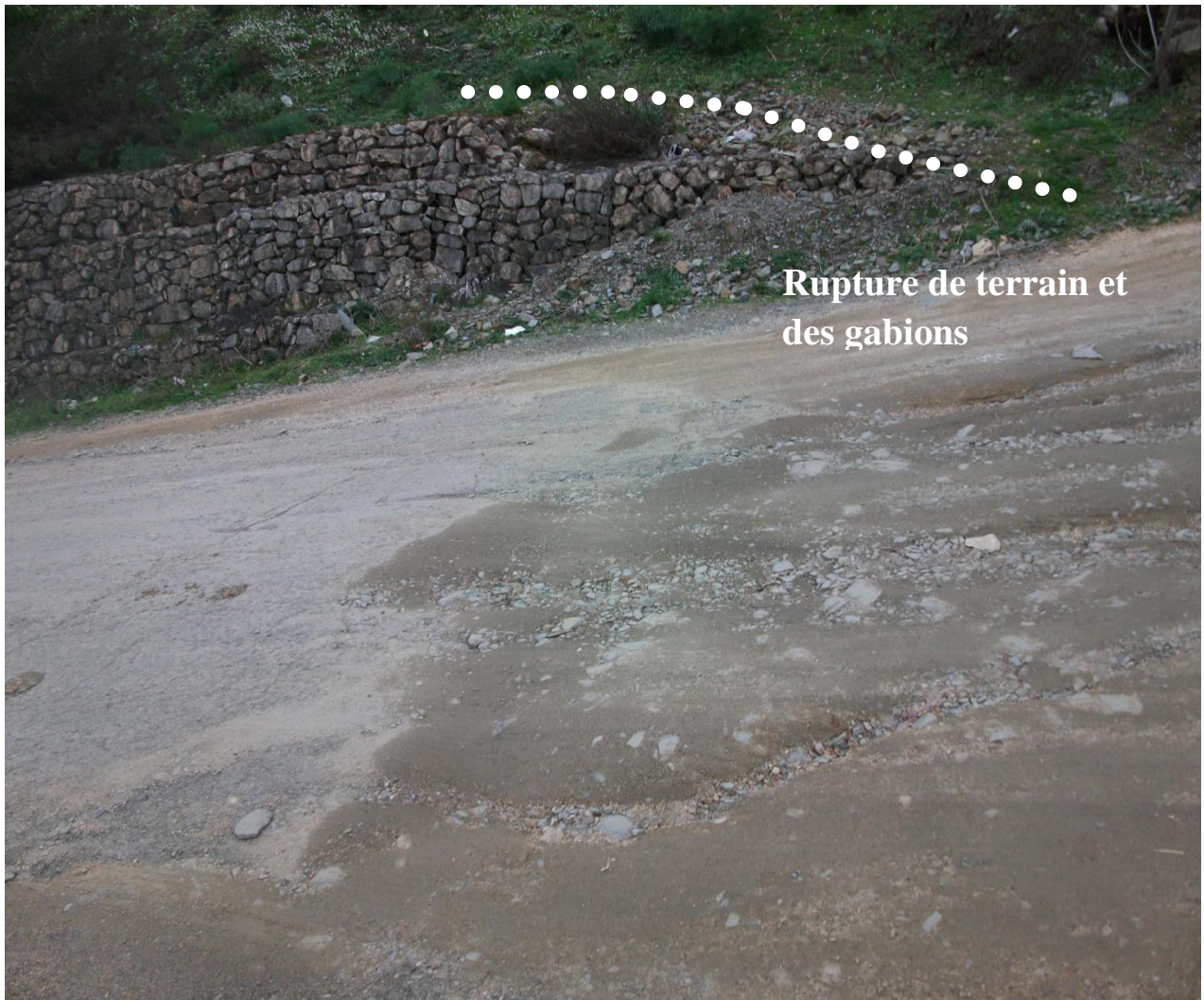
Figure V. 15 : Affaissements des gabions bordant la route qui mène vers le village Lazib ait Sidi Saïd
