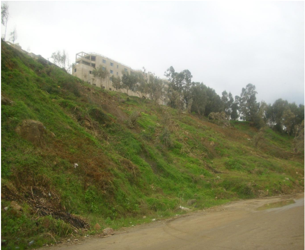
Figure III.1 : Niche d'arrachement et arbres basculés a cause d'un glissement de terrain a tizirt.
