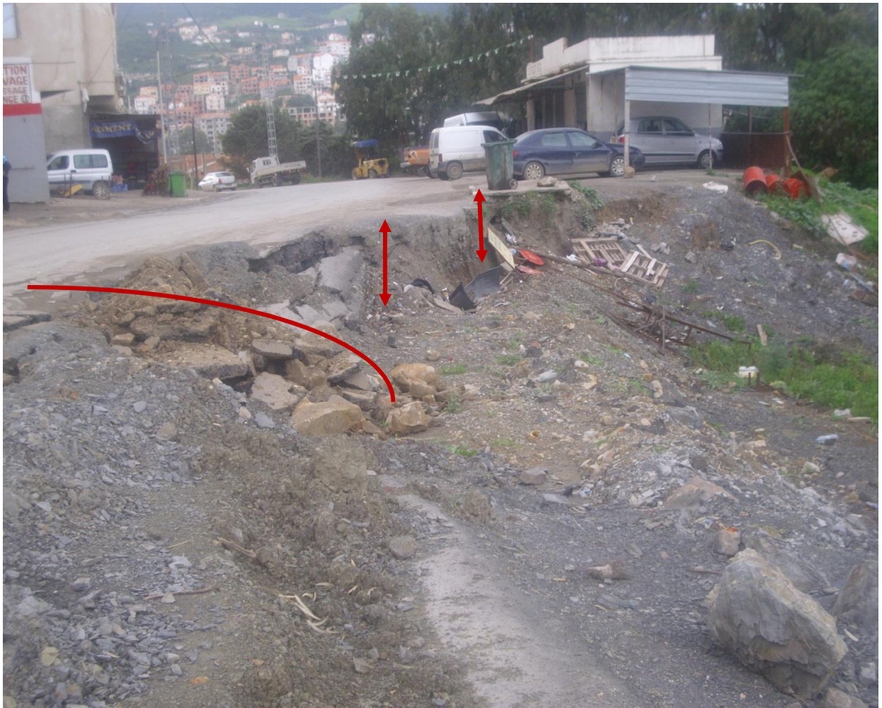
Figure III.7 : dégradation et Affaissement de la route à tizirt. Source: djerbal lynda janvier 2014
