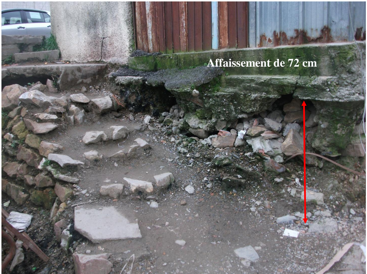
Figure V.3 : affaissement du terrain à l'entrée du marché
