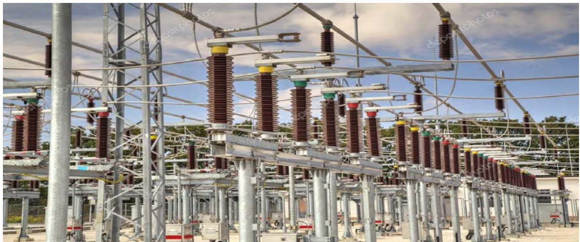
Figure II.3. Jeu de barre électrique haute tension
