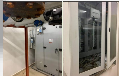
Figure 201 : vue sur locaux technique Source : auteurs
