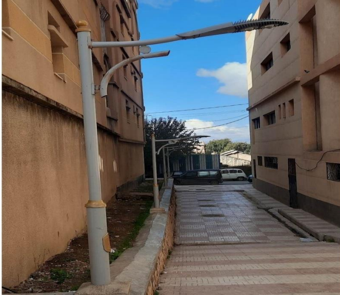
Image 18 : Luminaire LED à AZAZGA
