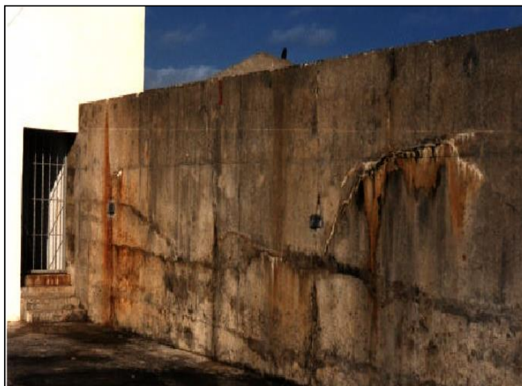
Figure IV.8. Fissures avec calcite et traces de rouille sur mur en béton.
