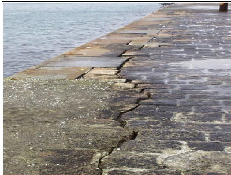
Figure IV.2. Fissuration du couronnement.
