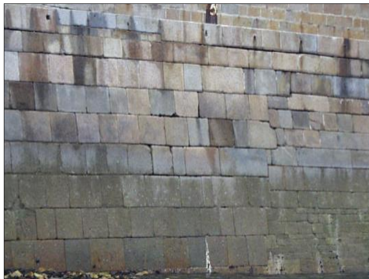
Figure IV.10. Joints de maçonnerie érodés.
