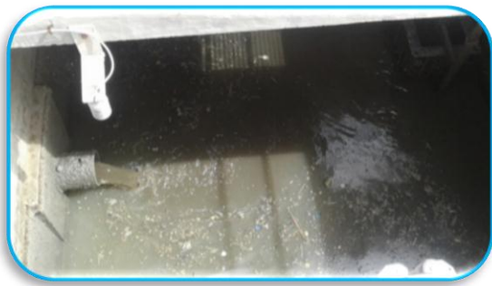
Figure 4 : poste de relevage
