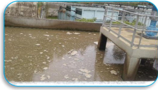
Figure 11 : bassin de dénitrification
