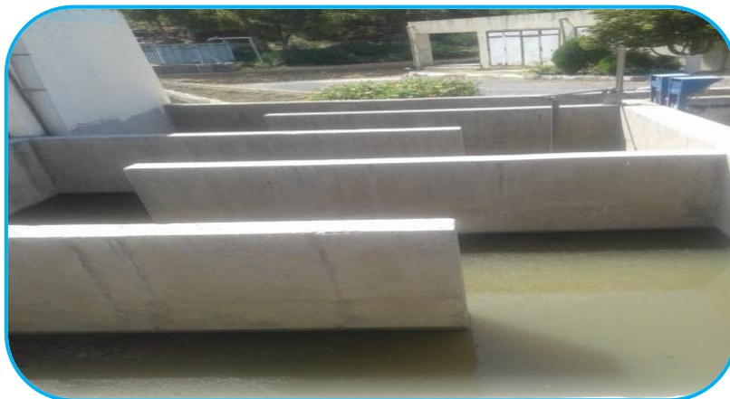
Figure15 : bassin de désinfection
