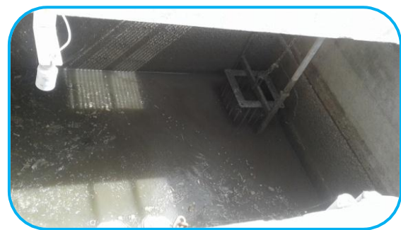
Figure 5 : dégrilleur grossier et la sonde de niveau
