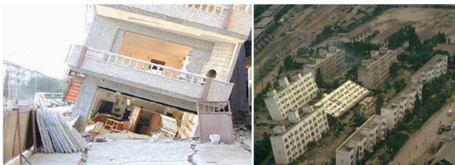
FIGURE 2.12 – Renversement de bâtiments suite à la liquéfaction du sol de fondation
