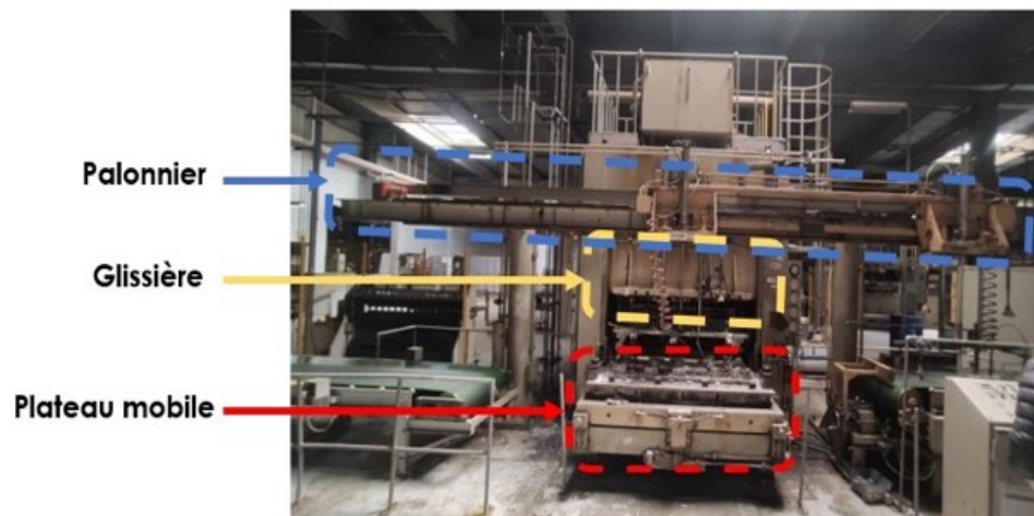
FIGURE 1.10 – Parties mécaniques de la presse hydraulique.
