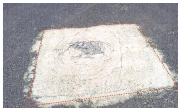
Réparation ponctuelle dégradée avec départ de matériaux.
