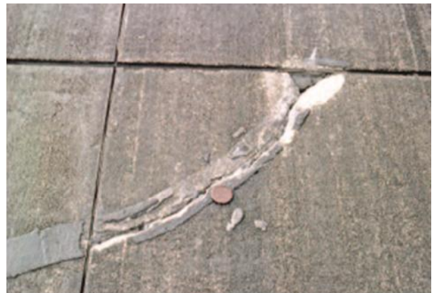
Fissure en coin (cassure d'angle) mal réparée.
