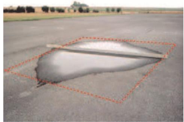
Flaches sur voie de circulation.
