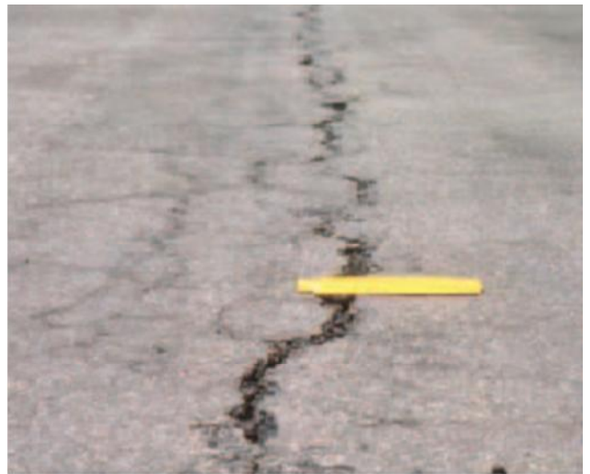
Fissure de fatigue avec départ de matériaux.
