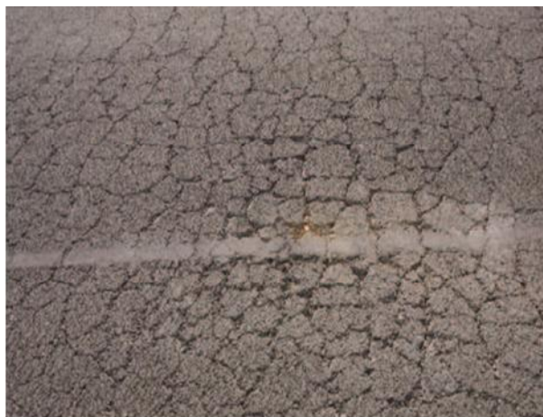
Faïençage de fatigue.
