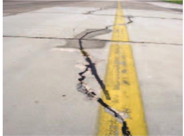
Fissure de dalle.
