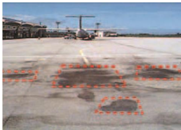
Contaminations (souillures) fuite d'huile.
