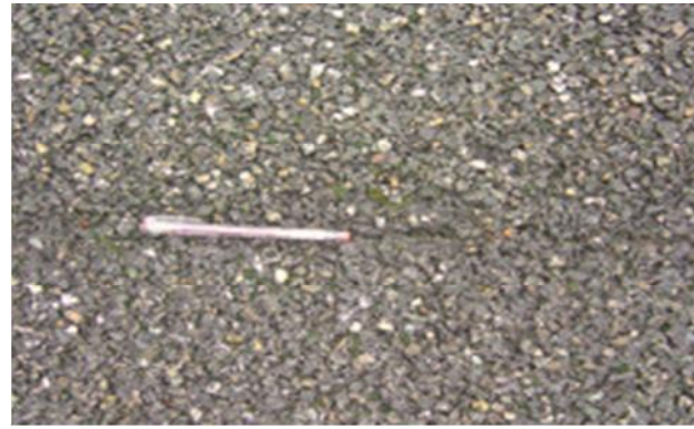
Enrobé poreux: (présence de mousse).
