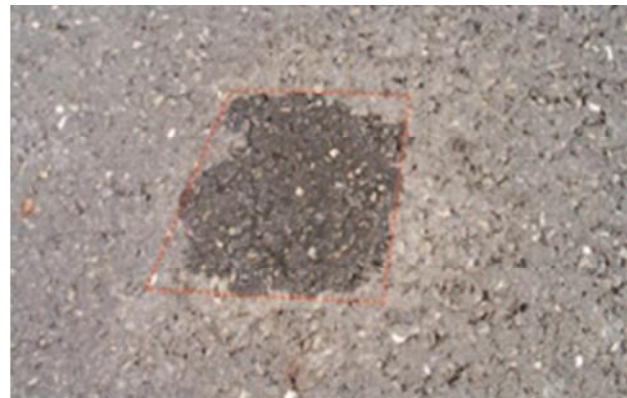
Remontée d'eau: vue rapprochée.
