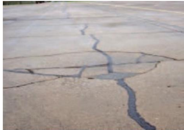
Fracture de la dalle.
