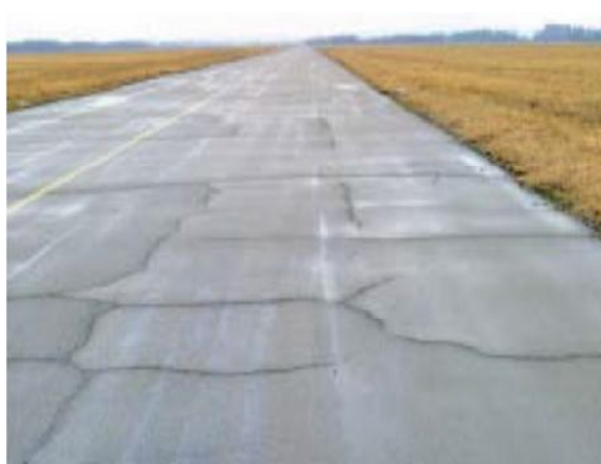
Fissures de retrait.
