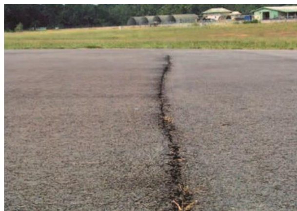
Fissure de joint entre deux bandes d'épandage.
