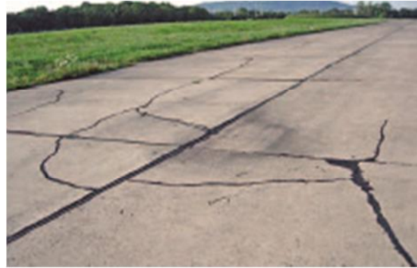
Pompage identifié par les dépôts de fines.
