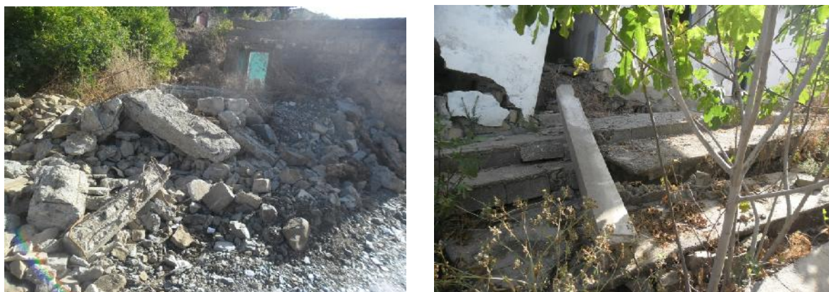
Fig III.15-2 : Constructions endommagées par le glissement (CHERGUI.2016).
