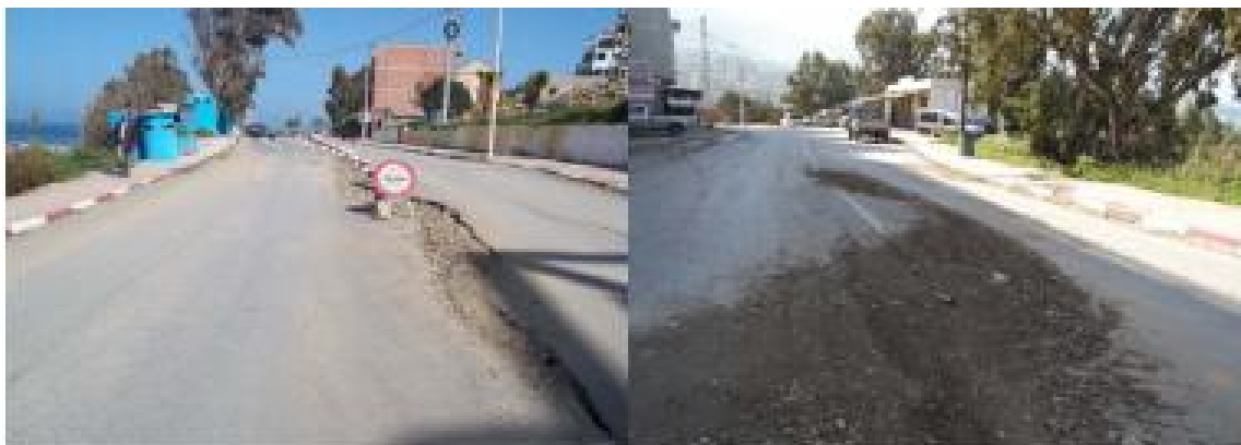
Fig III.11-2 : dégradation de la chaussée. (CHERGUI.2016)
