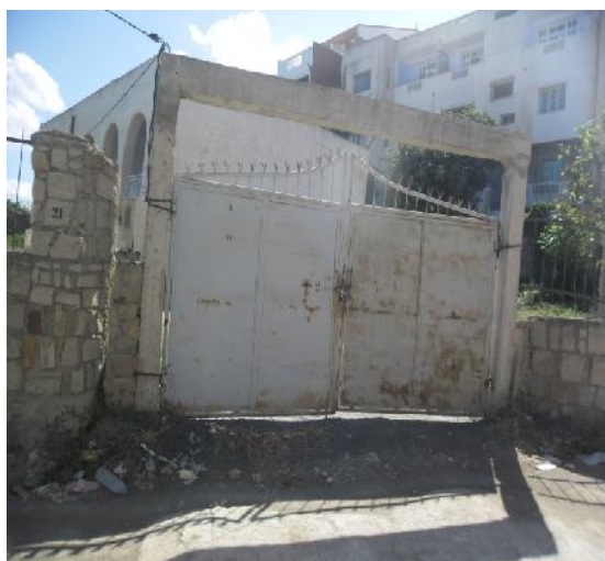
Fig III.10-7 : Rupture au niveau des poteaux. (CHERGUI.2016)
