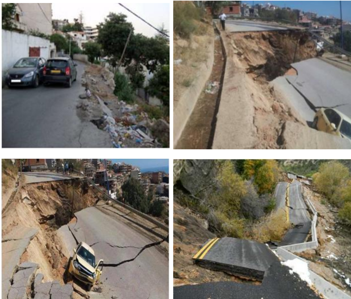
Fig III-37 : Désordre observés de glissement de Témelmy
