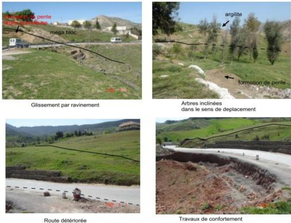
Fig III.98 : Glissements affectant la route. (DJENBA.2015)
