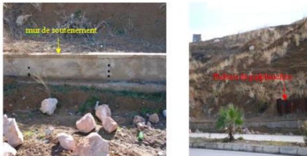
Figure III.79 : mur de soutènement affecté par le glissement
