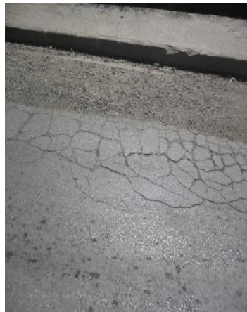
Fig III.13-7: Affaissement de CW. (CHERGUI.2016)
