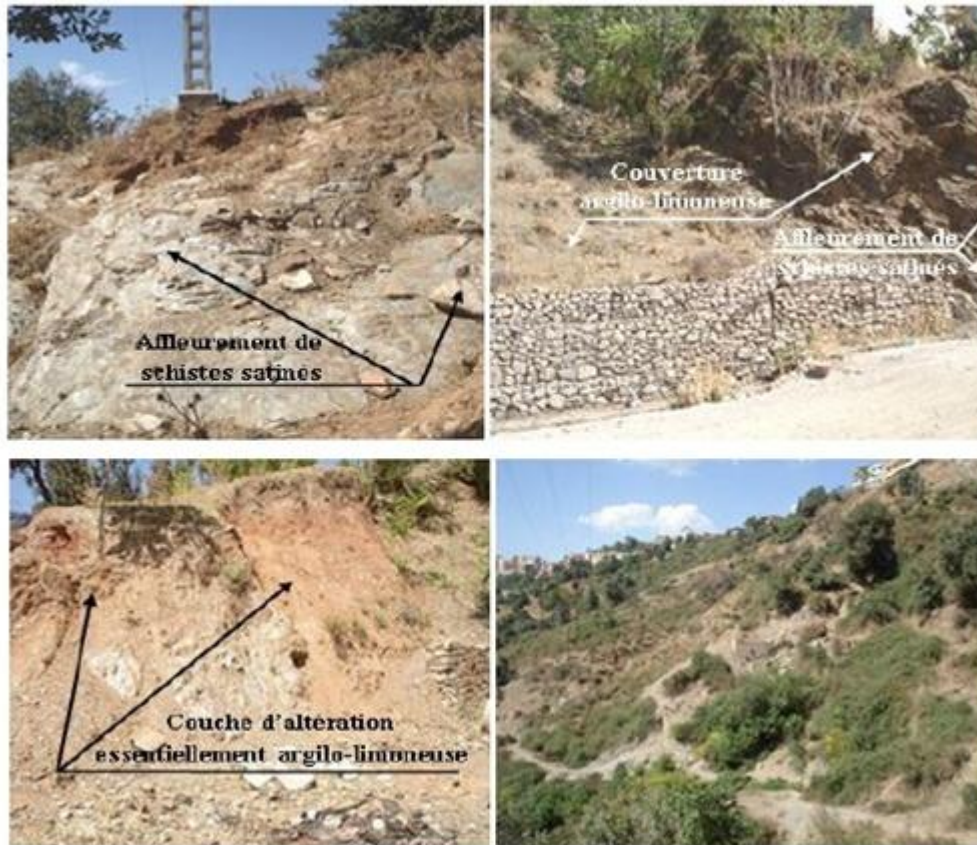
Fig II. 07 : Nature du sol de la zone instable (schistes satinés altéré surmontés d'une couche argilo- limoneuse). (BOUDLAL.2013)
