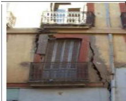
Fig III 52 : Bâtiment R+3, en maçonnerie, très endommagé, Quartier Bélouizdad. (BOUGDAL.2007)
