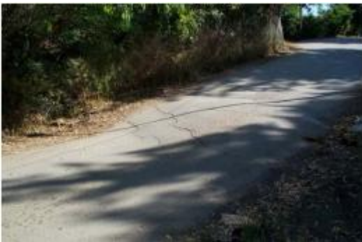
Fig III.88 : Affaissement et fissuration du chemin forestier, en amont du pont. (BOUGDAL.2007)
