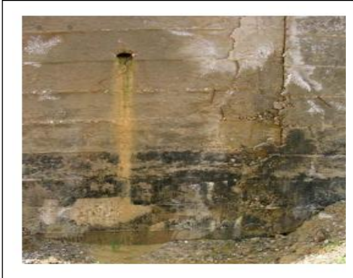
Fig III.73 : Sortie de drain et suintement d'eau sur mur de soutènement. Le massif fiftant derrières le mur n'a pas été réalisé. (BOUGDAL.2007)
