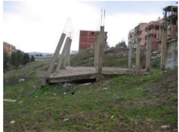
Fig III.70 : A environ 200 m au Sud des trois tours, l'évolution d'un glissement de terrain, a entièrement détruit quelques maisons en cours de construction. (BOUGDAL.2007)
