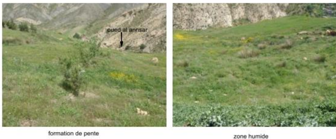
Fig III.99 : Vue des glissements avals. (DJENBA.2015)
