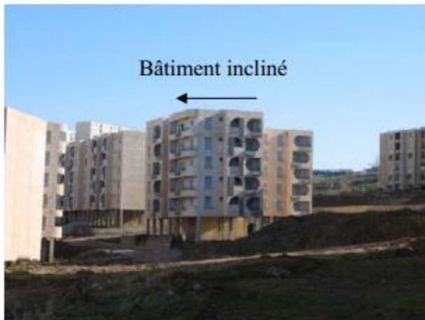
Fig III-69: La nouvelle cité CNEP, située dans la zone 1 montre par exemple, un bâtiment (R+5) franchement incliné, des joints excessivement dilatés et des murs de soutènement rompu. (BOUGDAL.2007)
