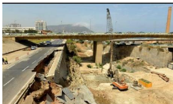
Fig III.39-10 : Désordre au niveau de l' autoroute
