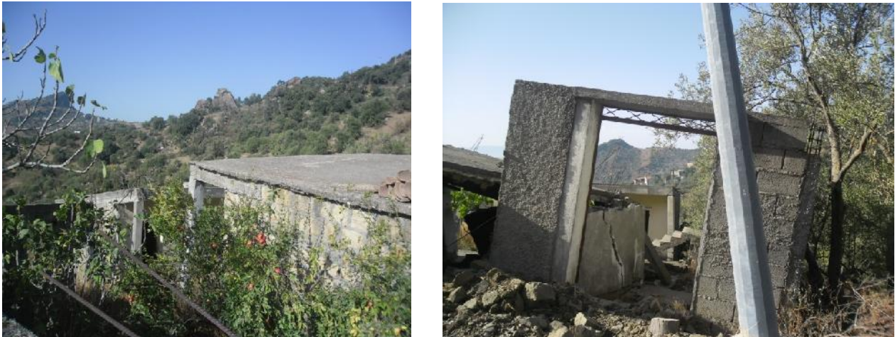
Fig III.15-7: Inclinaison des maisons et des poteaux électriques. (CHERGUI.2016)
