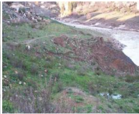
Fig III.45 : Talus aval instable, de la route du Bardo (rive gauche de l'oued Rhumel) (BOUGDAL.2007)
