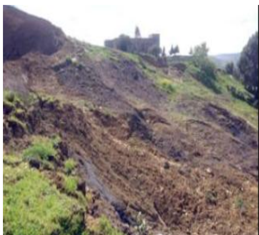
Fig III.39-7 : Escarpement du terrain
