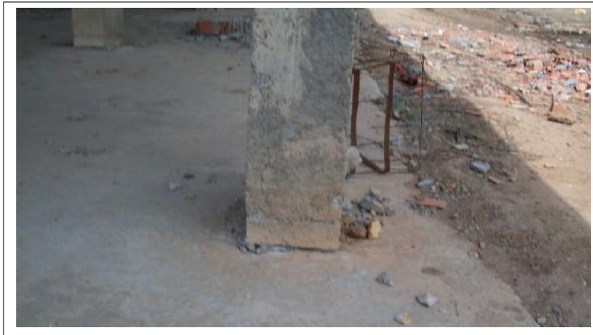
Fig III-31-9: Poteaux cisailés de l'immeuble Taleb Ahcène.
