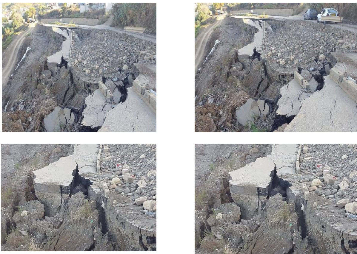
Fig III-102 : Désordres observés sur le CW03 à Tifra. Willaya de Bejaïa.
