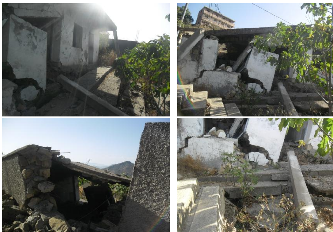
Fig III.15-5 : Dégradation des maisons . (CHERGUI.2016)
