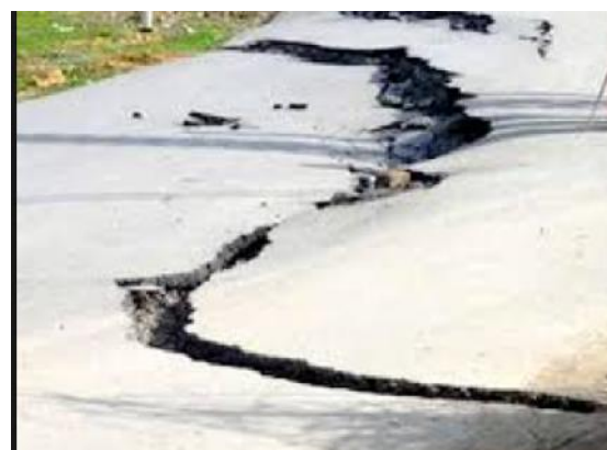
Fig III.39-4 : Désordre au niveau d'une chaussée
