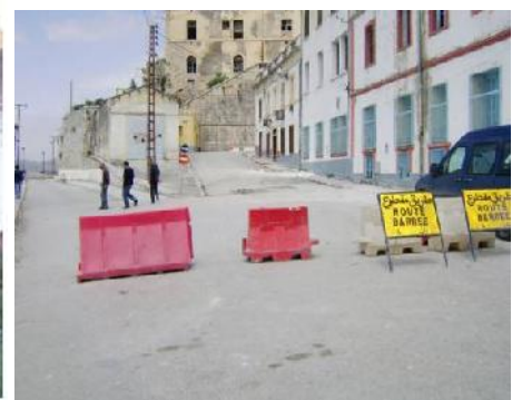
Fig III.46 : Route du Bardo affaissée et barée. (BOUGDAL.2007)
