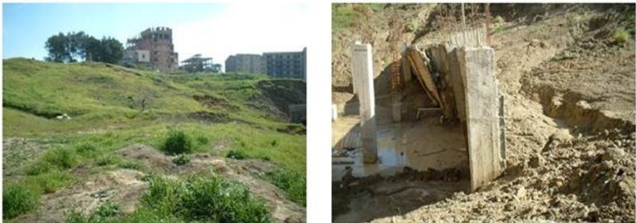
Figure III. 34 : Différents désordres enregistrés, (zone Nouveau Lycée). (BOUDLAL.2013)
