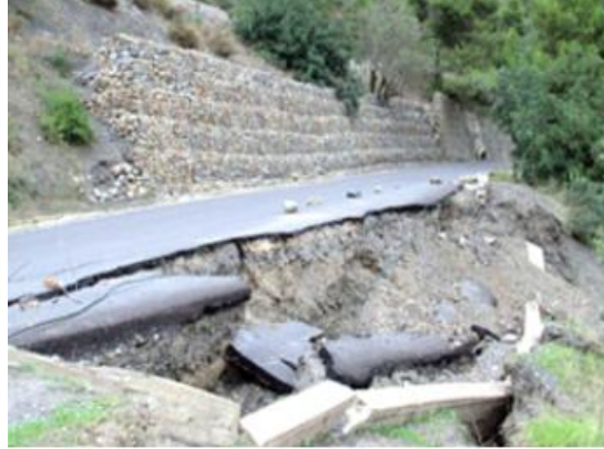
Fig III.39-2 : Dégradation de la chaussée
