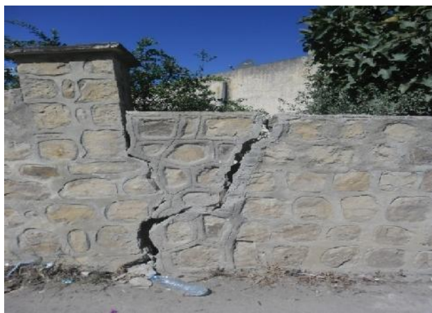
Fig III.10-4 : Fissuration importante d'un mur de clôture. (CHERGUI.2016)
