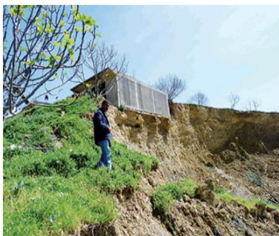
Fig III.39-5 : Maison menacée par le glissement
