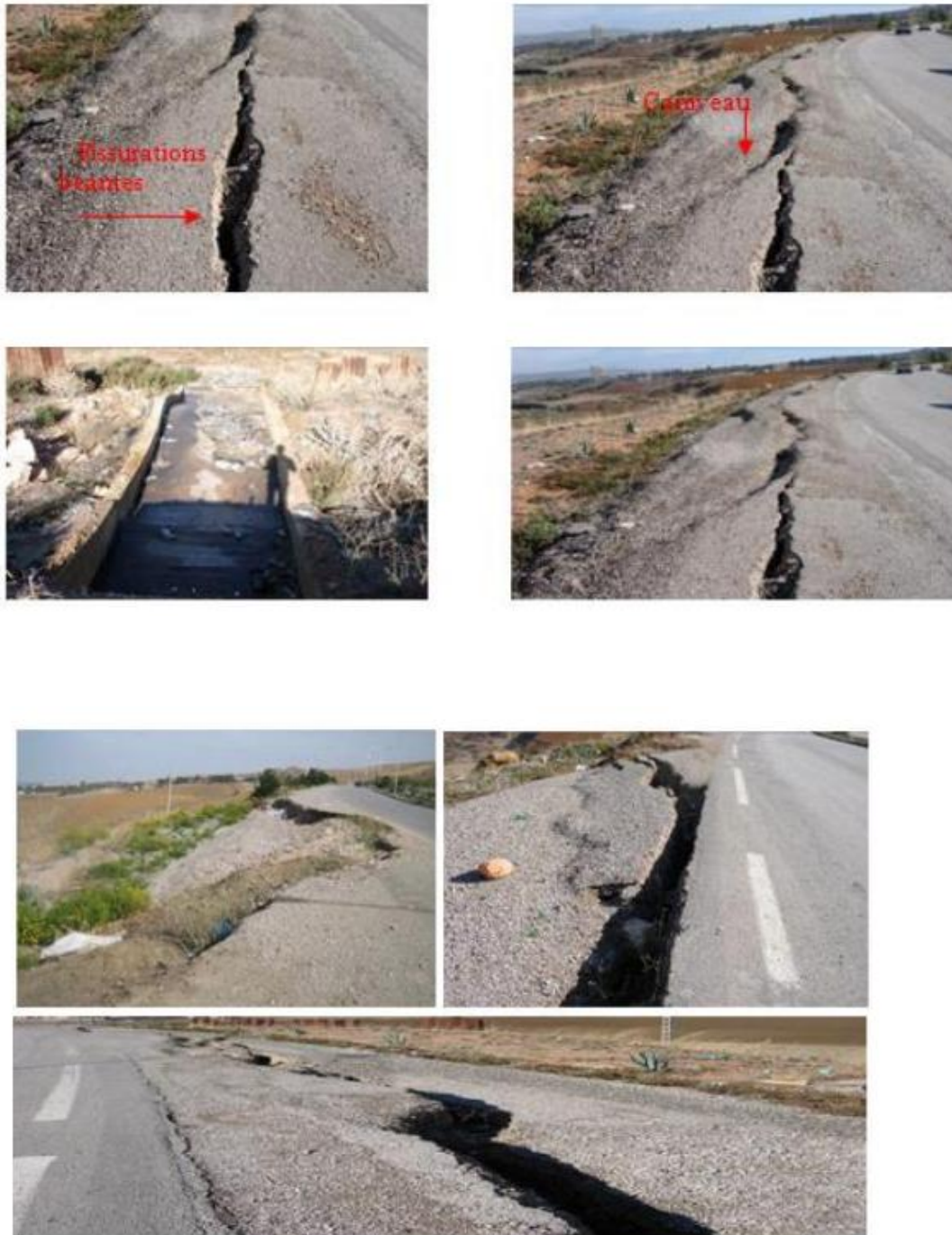
Figure III- 81 : Accotement dégradé par glissement de terrain
