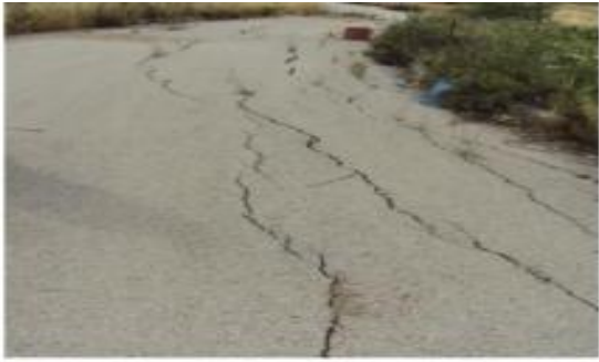
Fig III-56 : Affaissement au niveau de la rue.
