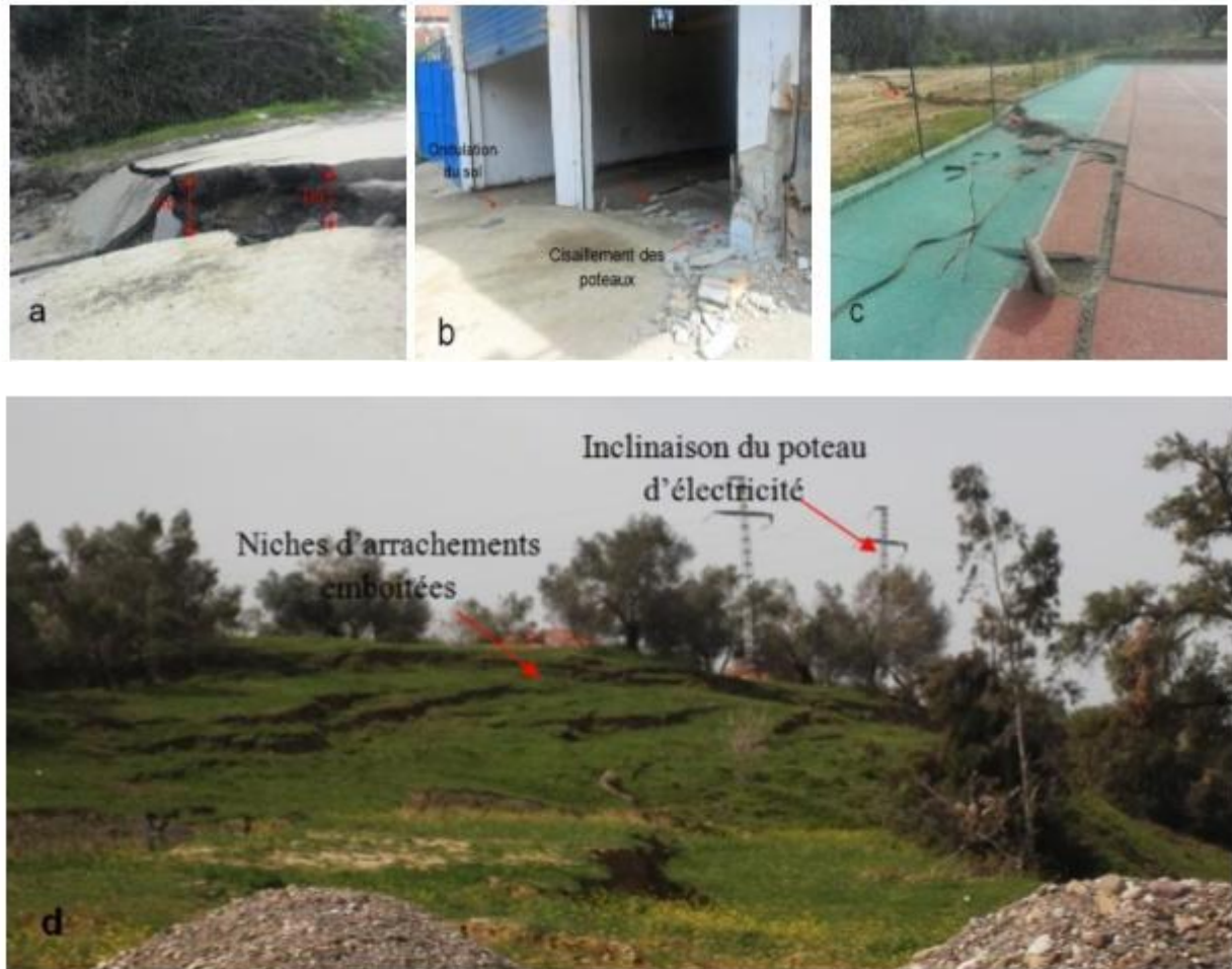
Fig III-18: Les désordres au niveau du glissement d'Azazga.(DJERBAL.2013)
