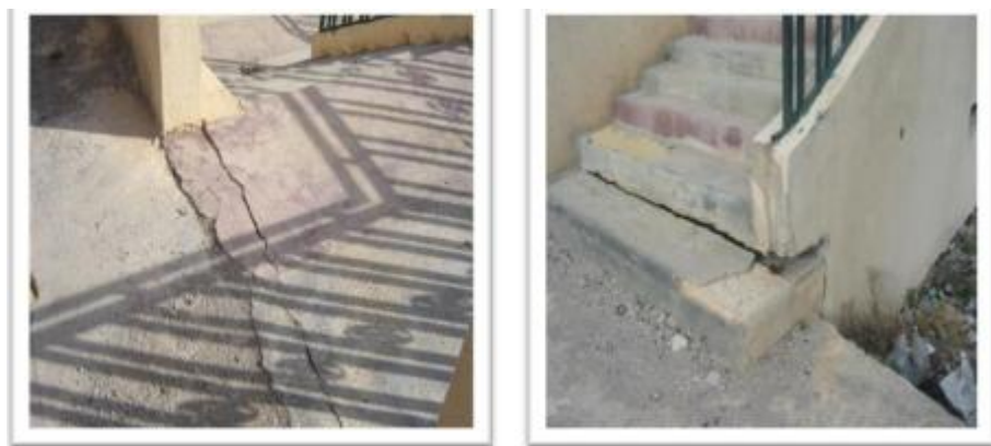
Fig III-66 : Tassement des escaliers
