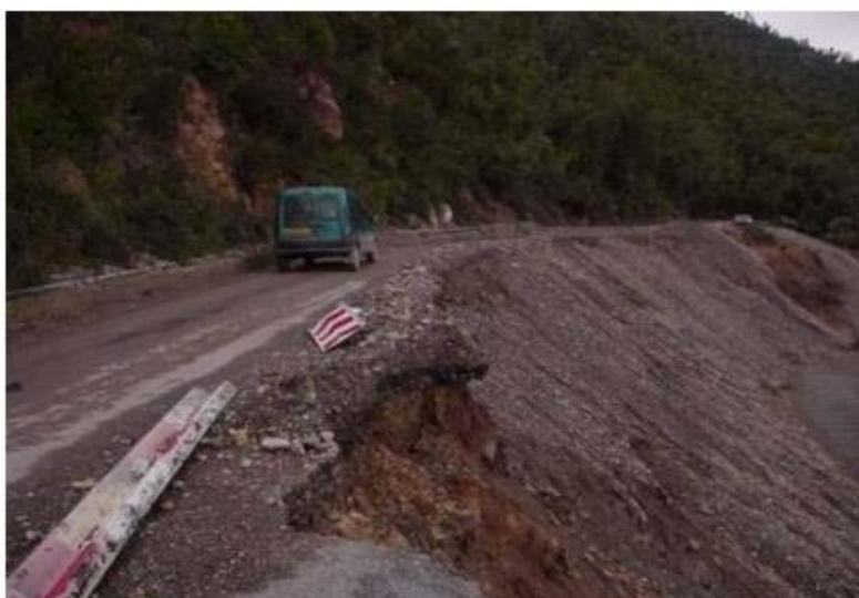
Fig III.101 : vue du glissement. (BENDJEDDOU.2015)
