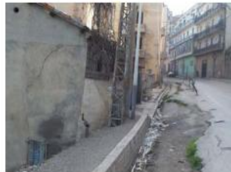
Fig III 53 : Rue affaissée et maisons Fissurées, Quartier Kitouni. (BOUGDAL.2007)
