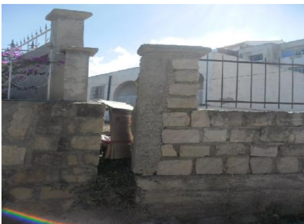
Fig III.10-3 : Ouverture importante d'un joint de rupture. (CHERGUI.2016)
