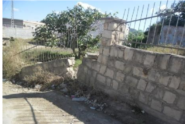
Fig III.10-2 : Dégradation d'un mur de clôture(CHERGUI.2016).
