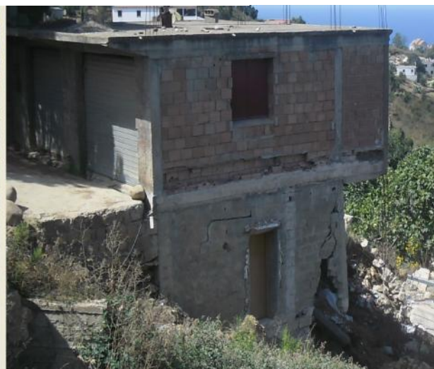
Fig III.13-5: cisaillement des poteaux au niveau du S/Sol. (CHERGUI.2016)
