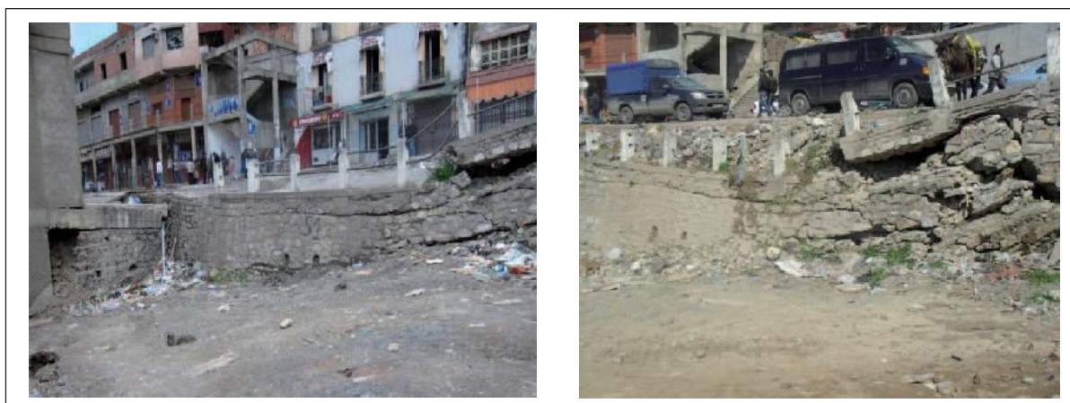
Fig III-31-4 : Désordres observés sur un mur de soutènement.
