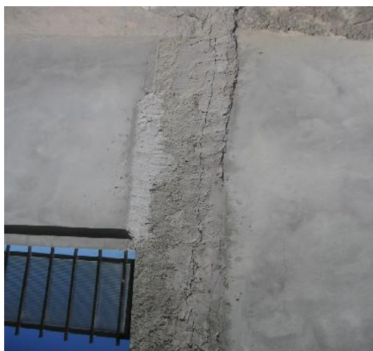
Fig III.10-8 : Fissuration léger après leur colmatage. (CHERGUI.2016)
