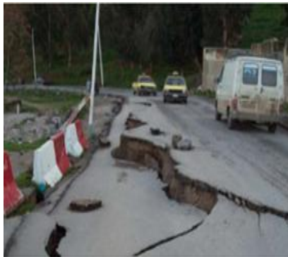
Fig III.44: Route du Bardo fissurée et affaissée (hiver2003).(BOUGDAL.2007)
