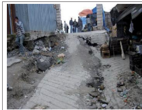
Fig III-31-2 : Affaissement de l'entrée de la zone du marché.
