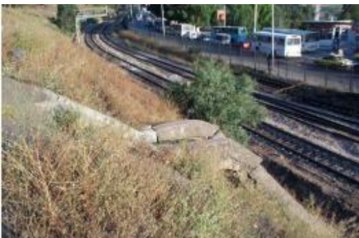
Fig III.89 : Déformation et fissuration de tous les ouvrages de drainage des eaux superficielles, talus amont de la plate-forme ferroviaire. (BOUGDAL.2007)
