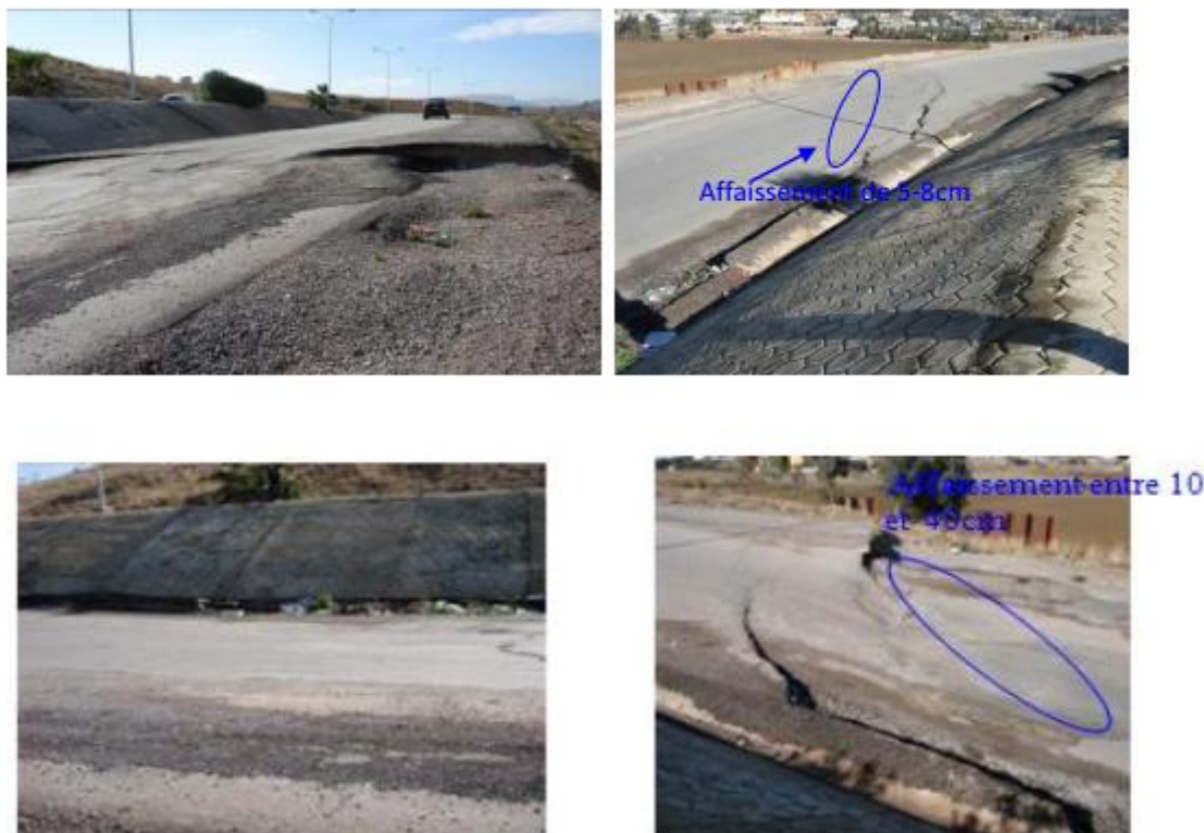
Figure III.80 : Dégradation de chaussée causé par le glissement
