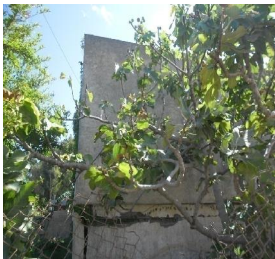
Fig III.10-5 : Dégradation d'un S/Sol. (CHERGUI.2016)
