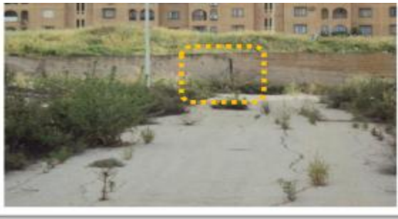
Fig III-58 : le disjointement du mur de soutènement par le glissement
