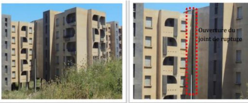
Fig III-59 : Ecartement entre les deux blocs 4 et 5- ouverture du joint 60cm.
