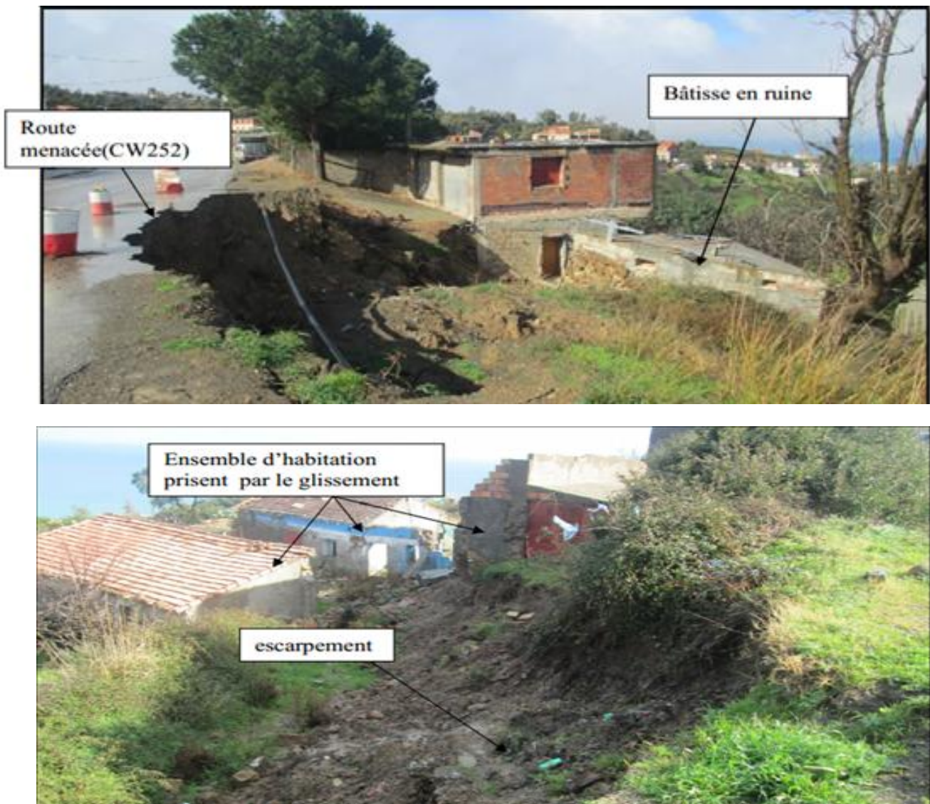
Fig III.12 : Photo prise sur site Village IKNACHE en 2015. (Etude géotechnique d'un glissement de terrain à IKNACHE-IGUERN'TALA.2015)
