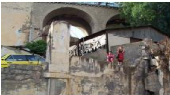
Fig III.86 : Constructions fissurées et abandonnées, sur le talus aval du pont. (BOUGDAL.2007)
