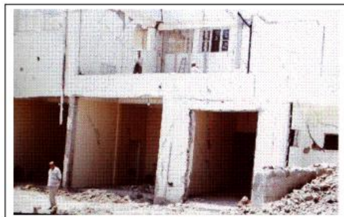
Fig III.91 : Dégradation par fissuration et basculement des Ateliers. (BOUGDAL,2007)
