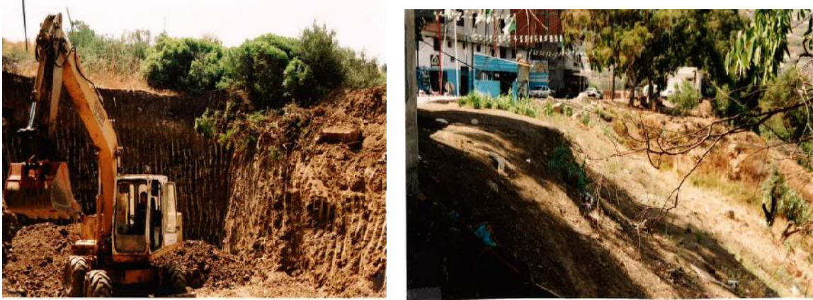
Fig III.11-3 : Glissement pendant la phase des travaux. (Rapport N° 01 ; Etude des glissements de terrain de Tizirt).
