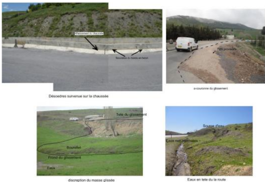
Fig III-95 : description de glissement sur la route nationale N° 9 de Dhiafet. (DJENBA.2015)
