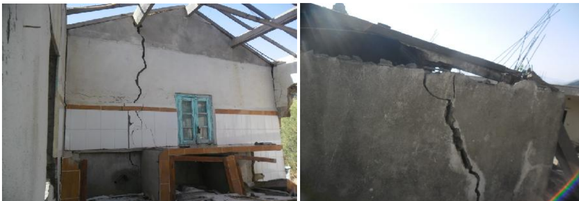
Fig III.15-1 : Fissuration des murs. (CHERGUI.2016)
