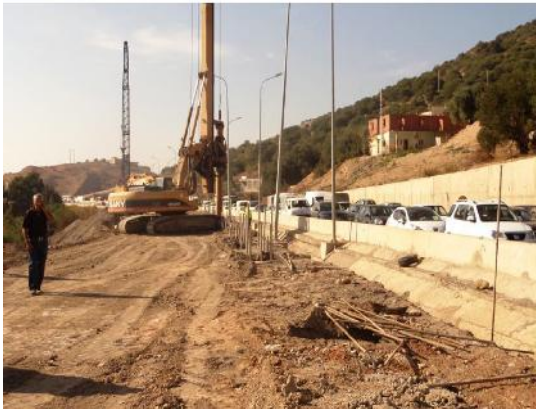
Fig III.39-1 : Désordre au niveau de l'autoroute
