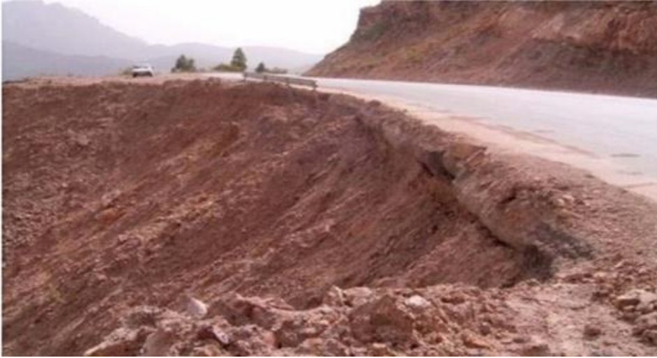
Fig III.106-b : vue de la zone de glissement.(BENDJEDDOU.2015)
