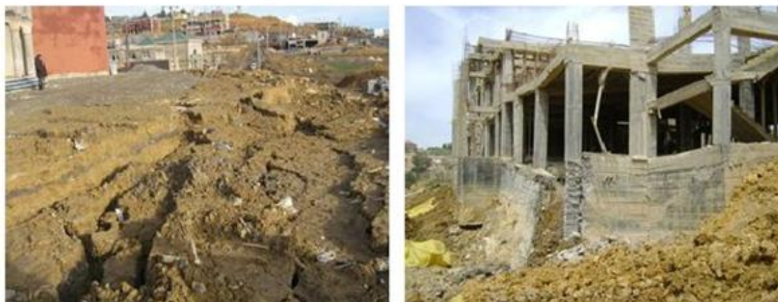
Figure III. 92 : Glissement de terrains, zone du nouveau lycée, (Médéa). (BOUDLAL.2013)
