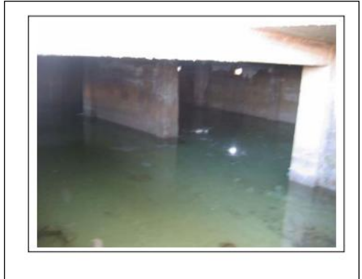
Fig III.74 : S/Sol de bâtiment constamment inondé, baignant dans la nappe superficielle argiles décomprimées.(BOUGDAL.2007)
