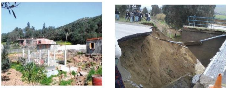
Fig III.33 : glissement de Talla Allam
