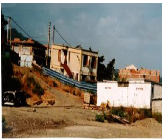
Fig III.10-10 : Inclinaison d'une maison en R+1. (CHERGUI.2016)
