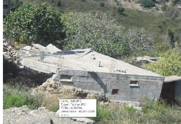
Fig III.13-2: inclinaison d'une maison en RDC. (CHERGUI.2016)
