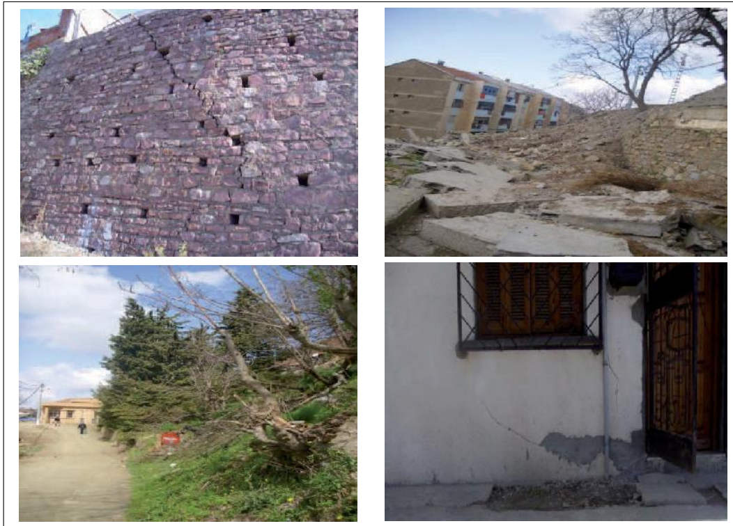
Fig III-31-7 : Instabilités observés dans en crête du versant en 2012.
