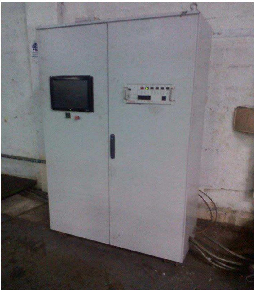
Photos V-1 : Vue extérieure de l'armoire.
