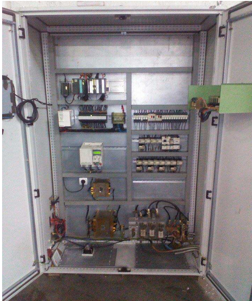
Photo V-2 : Vue intérieure de l'armoire.
