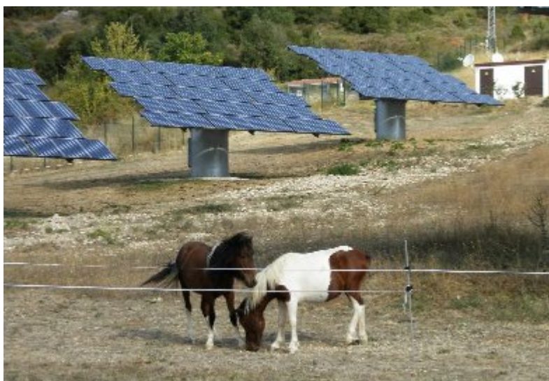
Figure (71) : exemple d'une installation photovoltaïque commandée par un suiveur du soleil.
