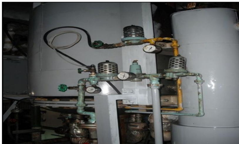
Figure III.11 : Réservoirs des produits R et P dans la salle MPU
