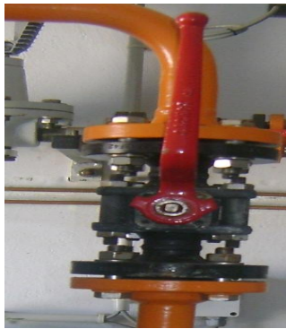
Figure I-4 : vanne manuelle (UXC-93558)
