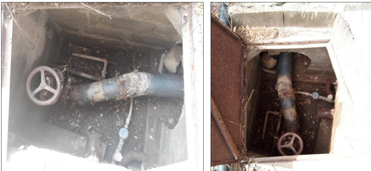
Figure (II.15) : Chambres des vannes du réservoir Belghozli 200m 3
