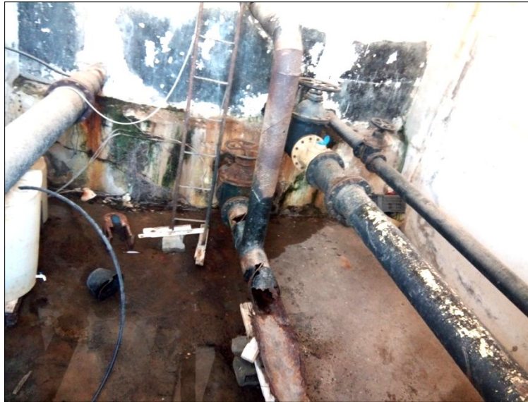
Figure (II.9) : Chambre des vannes de la bête 1000m 3 SR 1
