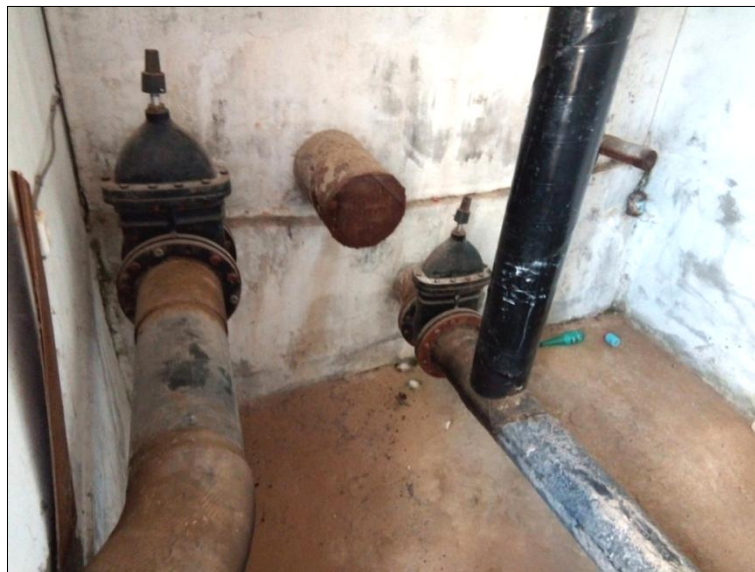
Figure (II.12): Chambre des vannes de la bâche Ait Zellal 500m 3 (SR 2 )
