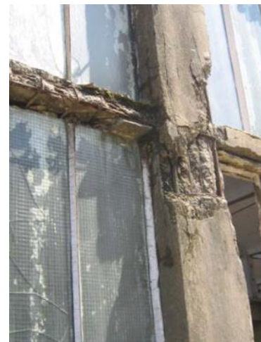
Photo 24 : Corrosion des armatures des parements de façade. (Source : mémoire de magister, Samia Bouaziz, 2011)
