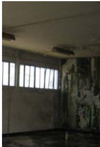
Photo 21 : Salissures dues aux infiltrations des eaux, (source : mémoire de magister, Samia Bouaziz, 2011)
