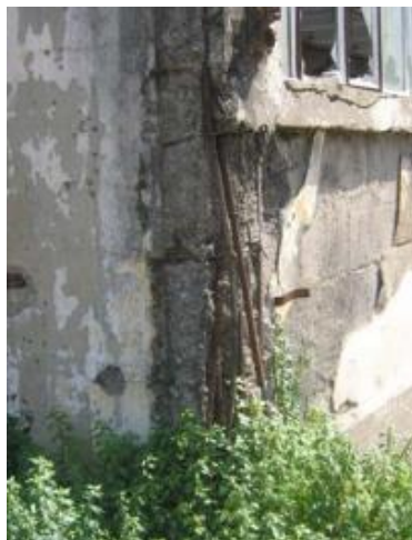
Photo 23 : Corrosion d'armatures d'un poteau de rive. (Source : mémoire de magister, Samia Bouaziz, 2011)
