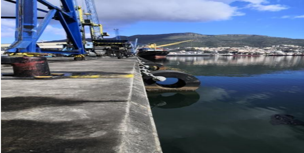
Figure 3.35. Poste 5 après le séisme (2021) de Béjaïa
