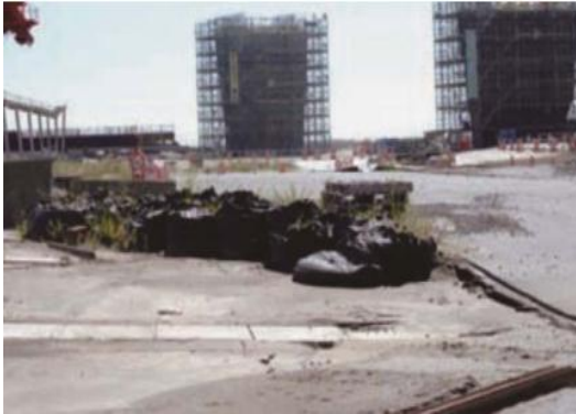
Figure 2.9. Grande zone de liquéfaction d'un quai lors du Grand Séisme à l'Est du Japon
