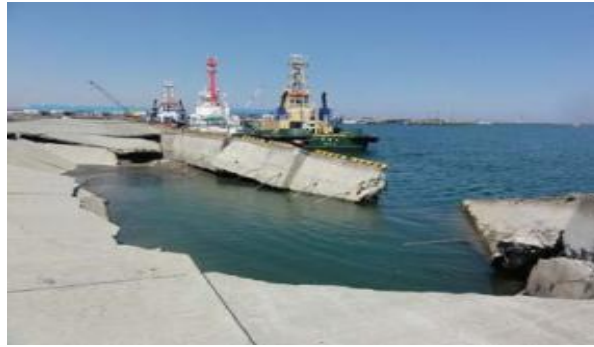
Figure 2.10. Dommages causés par le séisme de Tohoku en Japon
