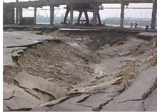
Figure 2.8. Grande zone de liquéfaction sur un quai lors du tremblement de terre de Chi-Chi Taïwan
