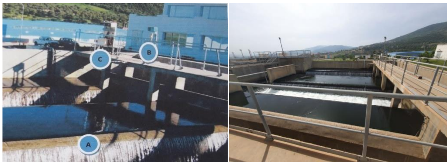
Figure 4 : Ouvrage d'entrée d'eau brute
