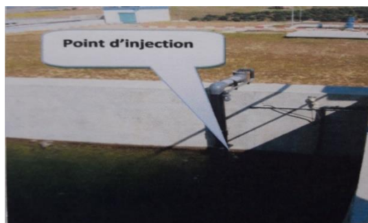
Figure 5: Point d'injection du chlore en pré-chloration
