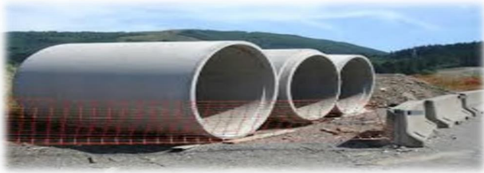
Figure I.7 : Conduite en béton non armé
