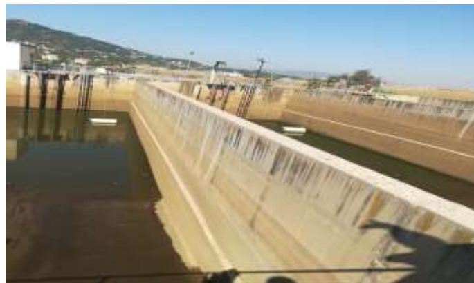
Figure III.16 : Dessableurs (bâche à eau)
