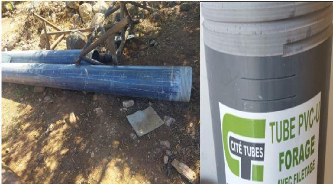
Figure 60 : les tubes en PVC
