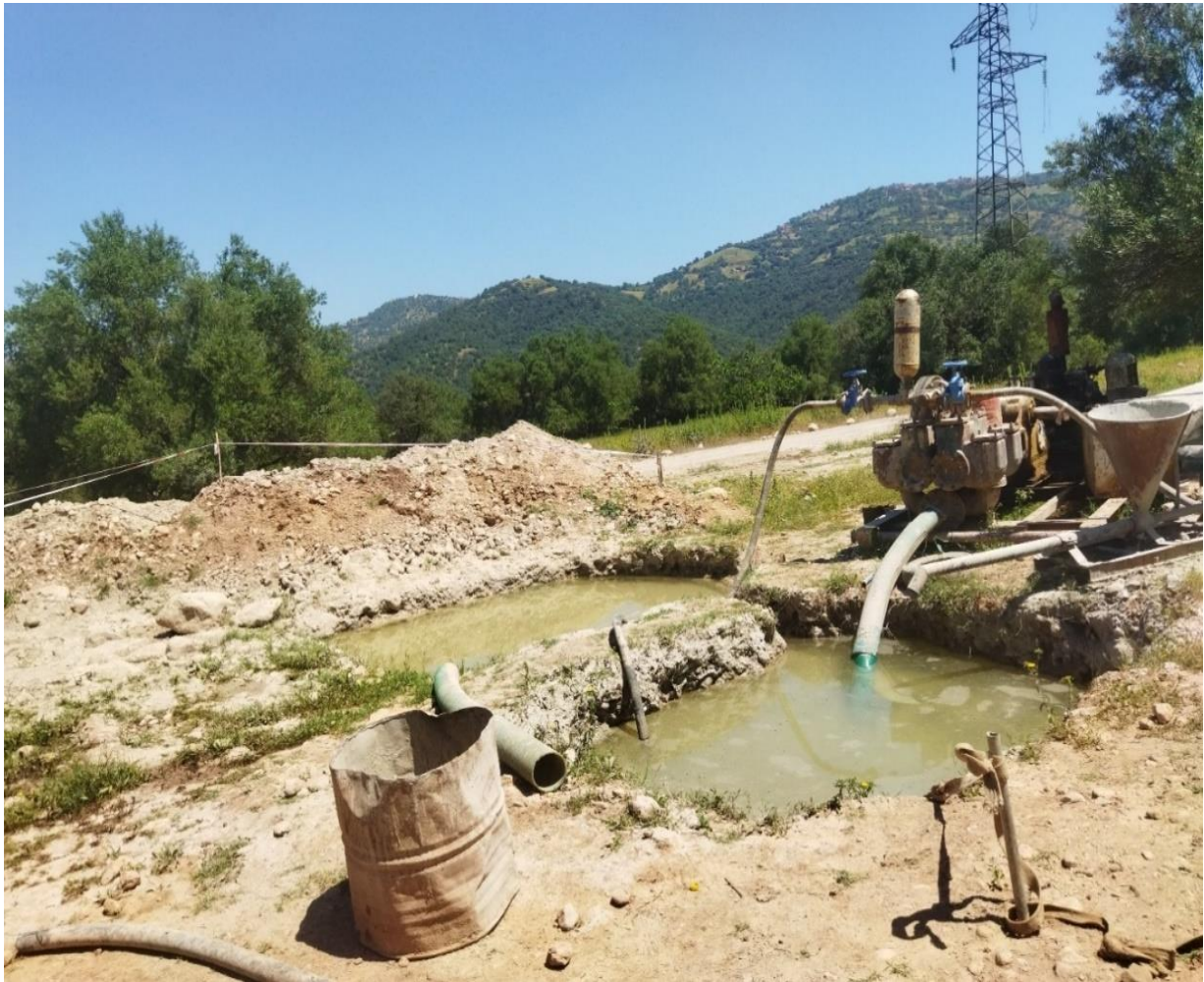
Figure 57 : les bassins à boue
