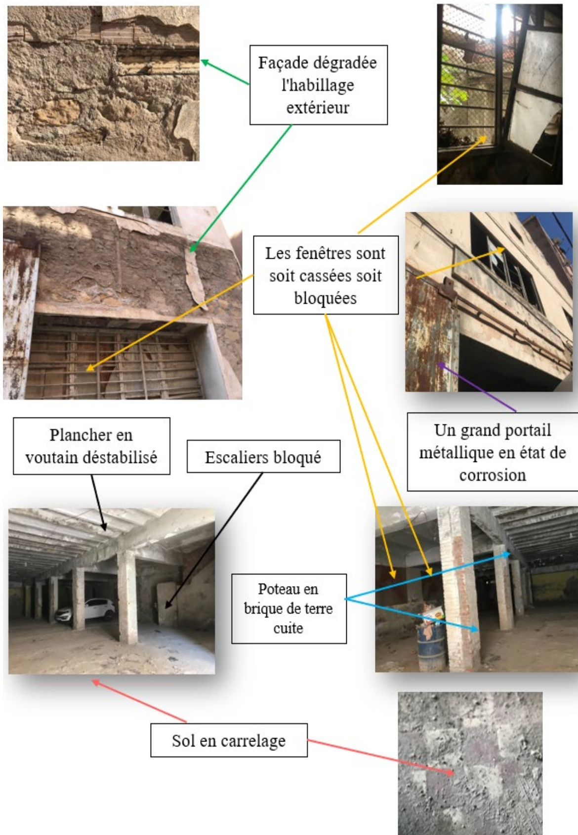
Figure 15: Relevé photographique des pathologies Source : Auteur
