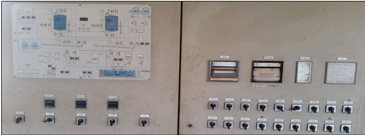
Figure.7 : armoire de commande
