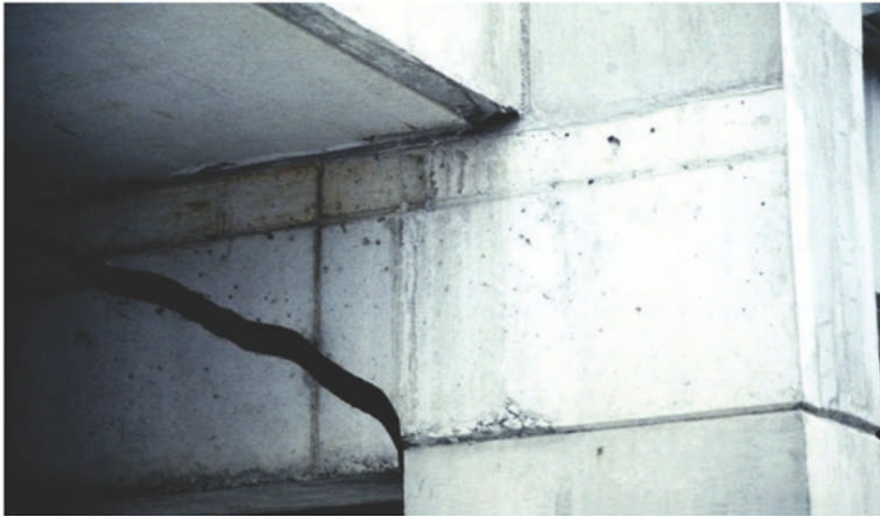
Figure I.14 : Rupture en cisaillement d'une poutre
