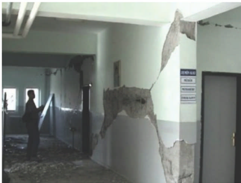
Figure I.15 : Rupture en cisaillement d'un mur (séisme de Turquie, mai 2003)
