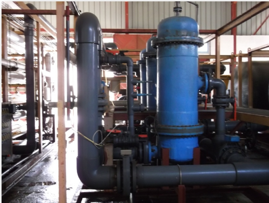
Photo 5 Les trois filtres de sécurité
