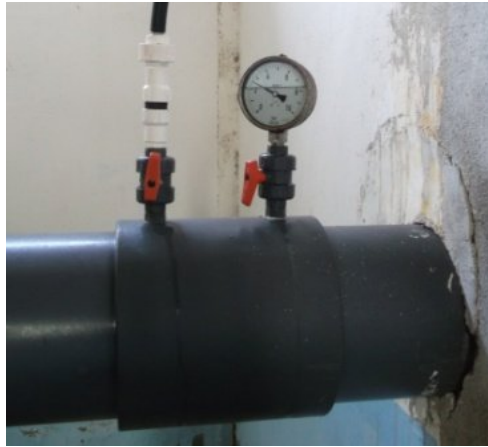
Photo 2 Point d'injection de l'acide chlorhydrique
