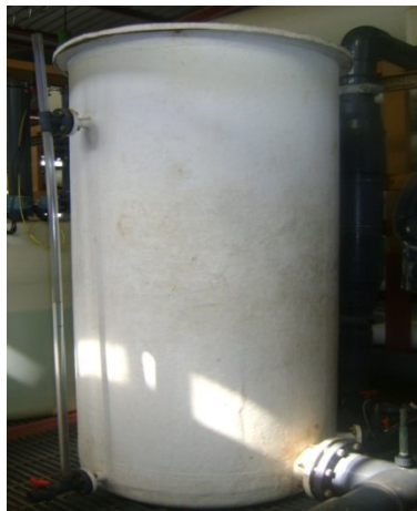
Photo 8 Réservoir tampon de stockage de l'eau traitée
