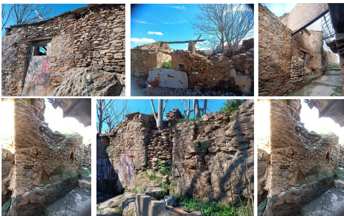
Fig.4.55-62. Dégradations des maisons 2 et 3 causées par l'infiltration. Source. Auteurs.
