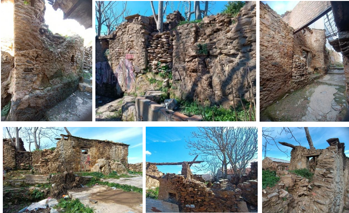
Fig.4.37-42. Dégradations des maisons 2 et 3. Source. Auteurs.
