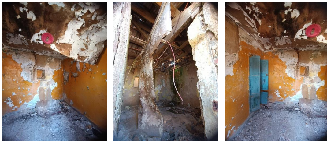
Fig.4.64-69. Dégradations de la maison 5 causées par l'infiltration. Source. Auteurs.
