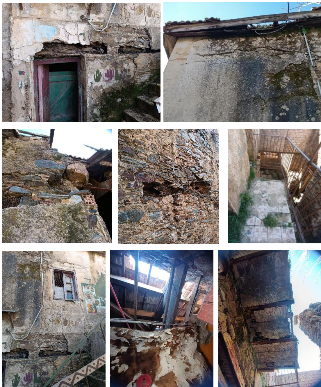
Fig.4.44-51. Dégradations de la maison 5. Source. Auteurs.
