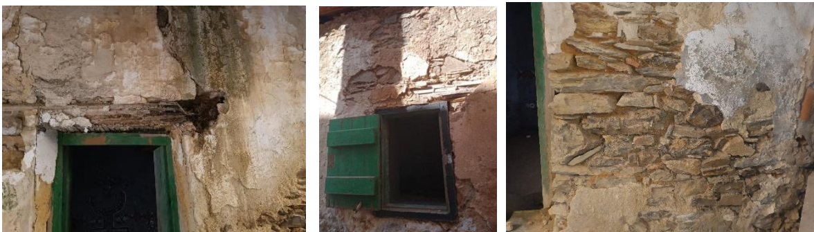
Fig.4.34-36. Dégradations de la maison 1. Source. Auteurs.
