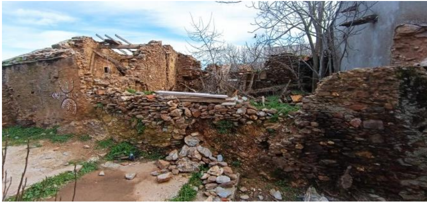
Fig.4.63. Dégradations de la maison 4 causées par l'infiltration. Source. Auteurs.
