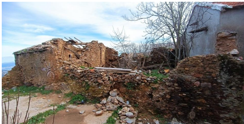
Fig.4.43. Dégradations de la maison 4. Source. Auteurs.
