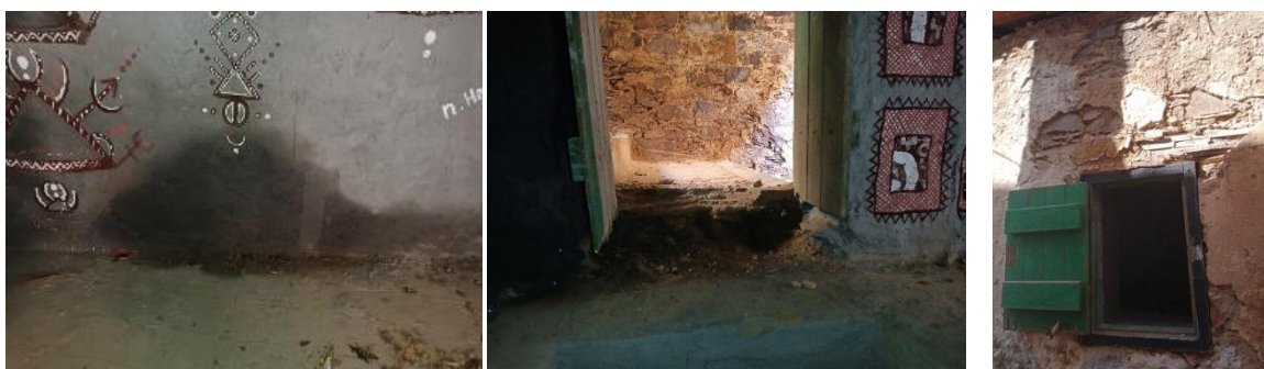
Fig.4.52-54. Dégradations de la maison 1 causées par l'infiltration. Source. Auteurs.
