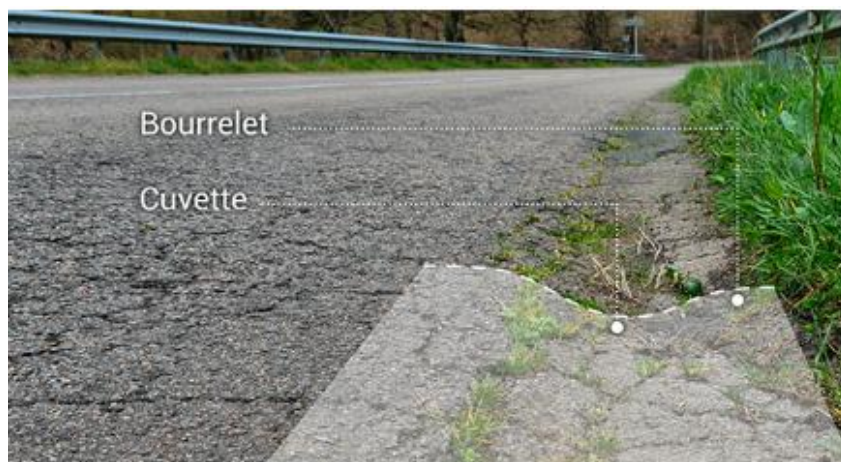
Figure 1. 16. Exemple d'un affaissement de rive [30]
