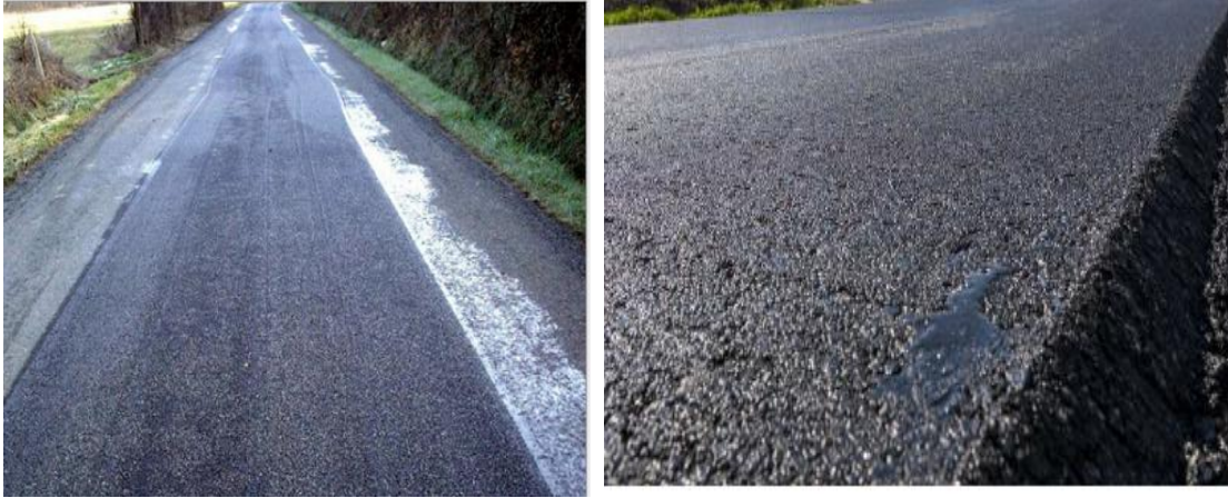
Figure 1. 27. Exemples des remontées sur le revêtement bitumineux [39]
