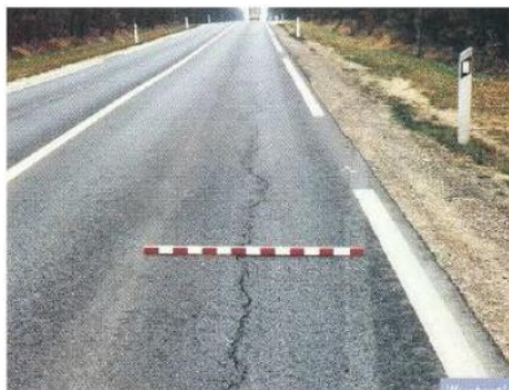
Figure 1. 21. Exemple d'une fissure longitudinale [9]
