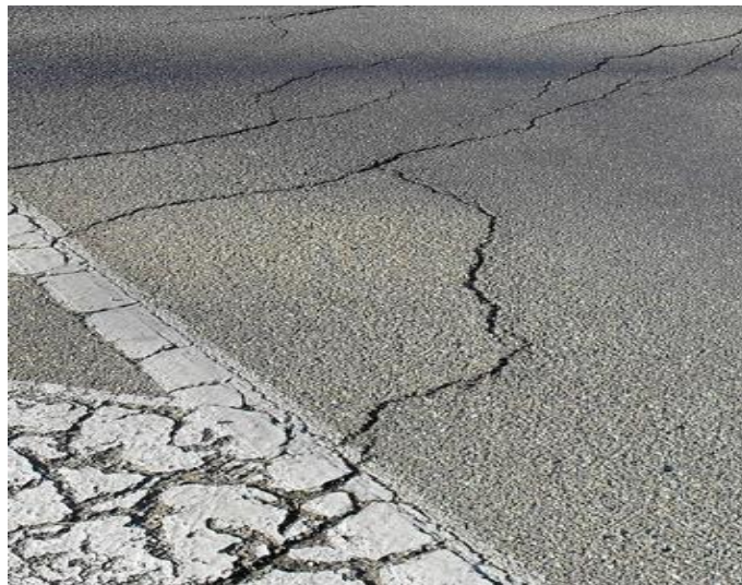
Figure 1. 23 Exemple des fissures diverses dans une chaussée [30]
