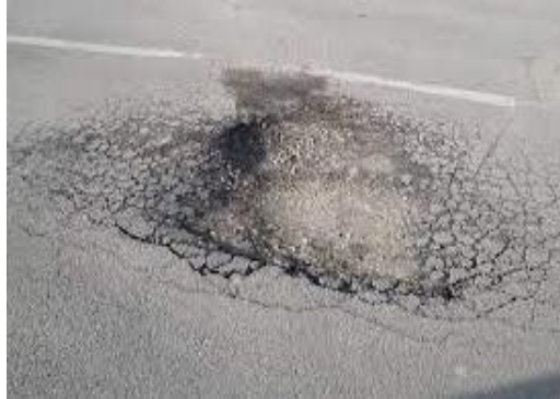
Figure 1. 24 Exemple d'un nid de poule dans une chaussée [9]
