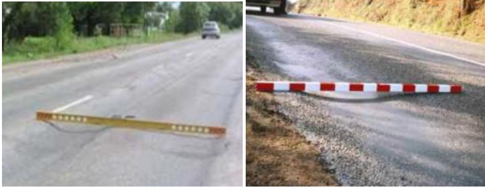
Figure 1. 17 Exemple de déformation d'orniérage [31]
