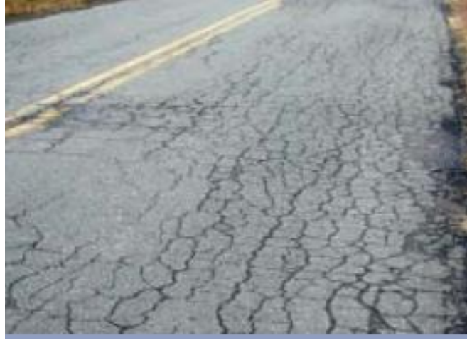
Figure 1. 22 Faièçage moyen sur une chaussée [30]
