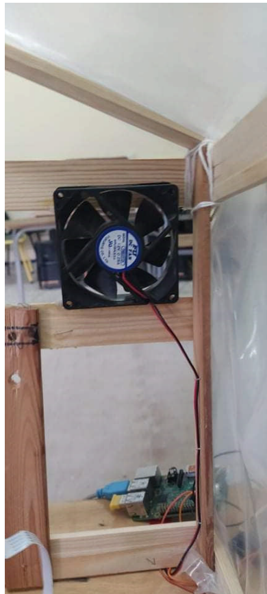
Figure 62 :L'état non actif du ventilateur
