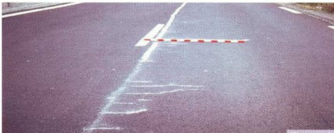
Fig I.15 : Remonté des fines : dégradation franche, significative et étendue (LCPC, 1998).
