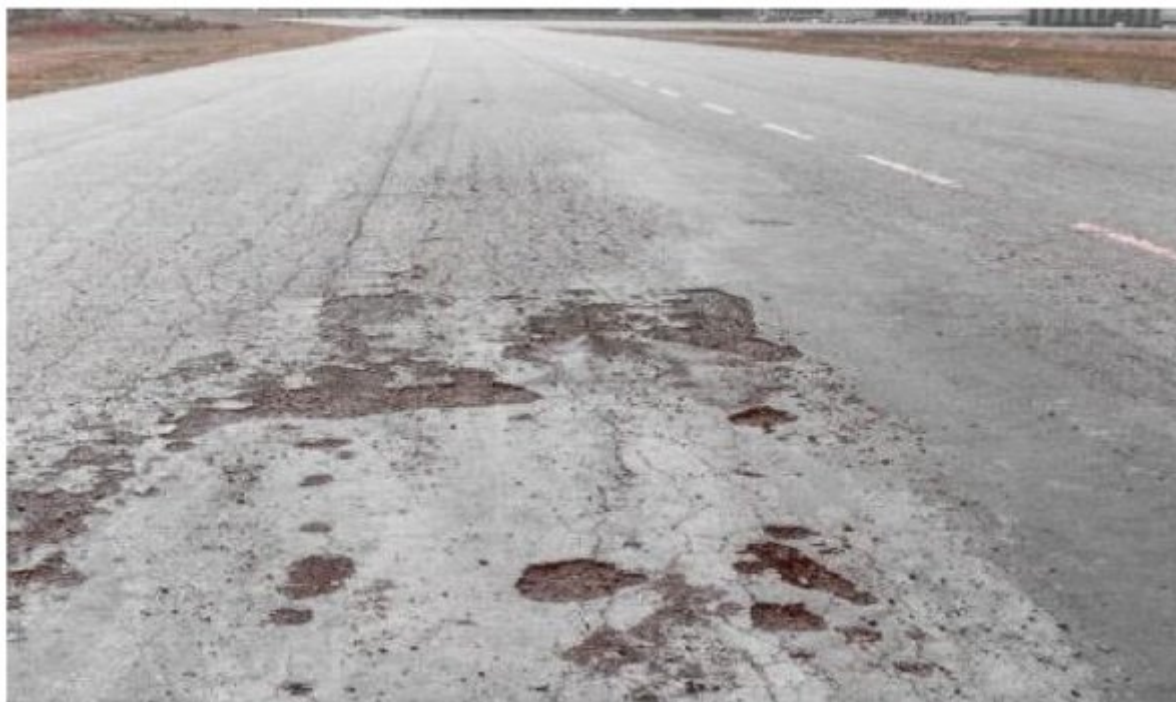
Fig I.14 : Dégradation d'arrachement (LCPC, 1998).
