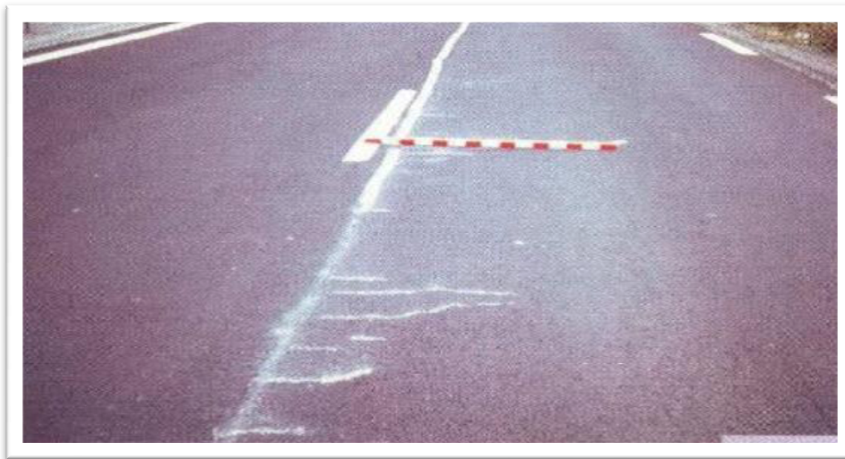
Figure 8.I. Remonté des fines: dégradation franche, significative et étendue (LCPC ,1998).
