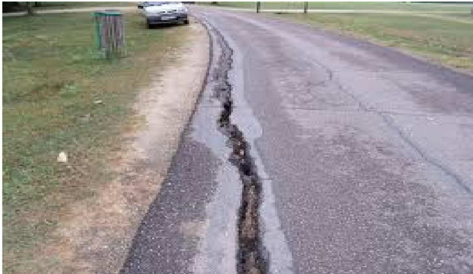
Figure 10.I. Fissures dans une chaussée.
