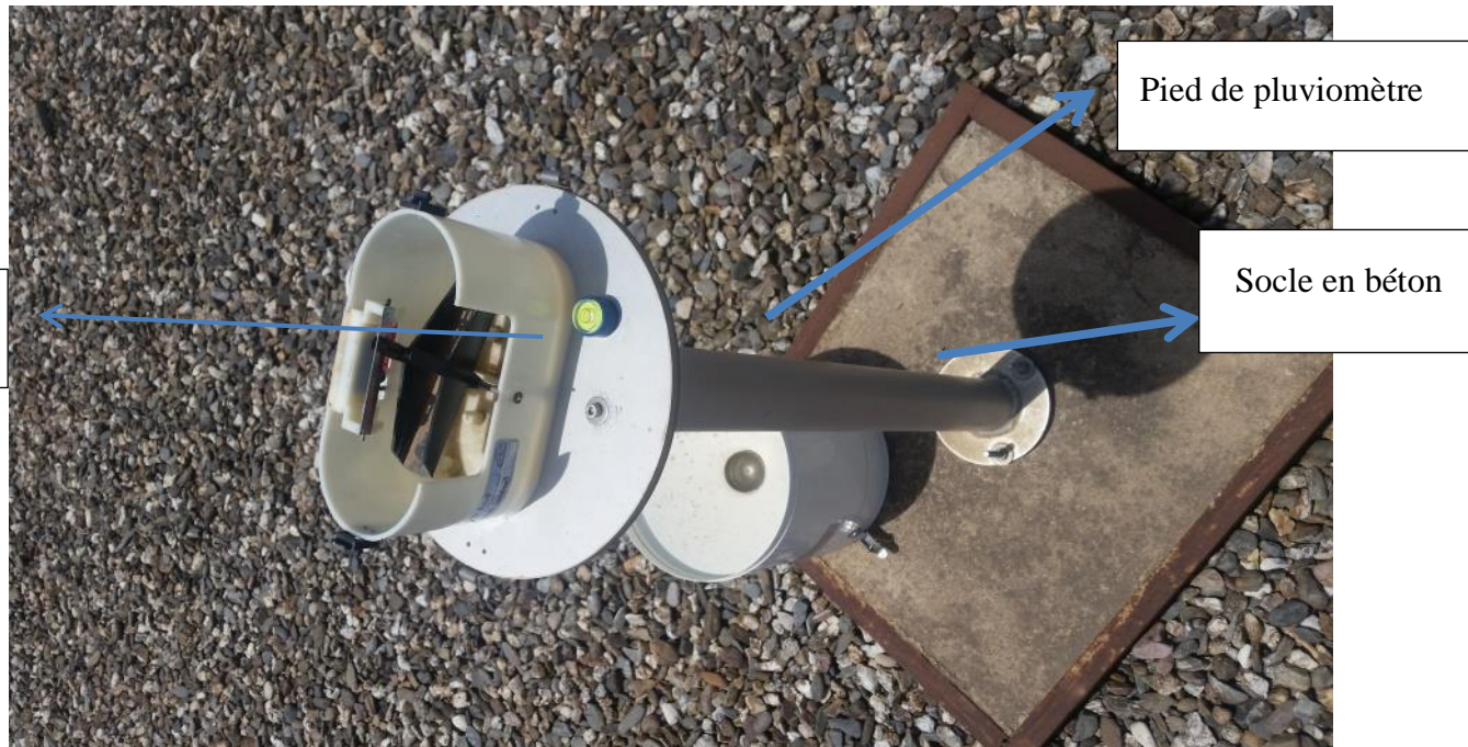
Figure 3 .Installation de Pluviomètre
