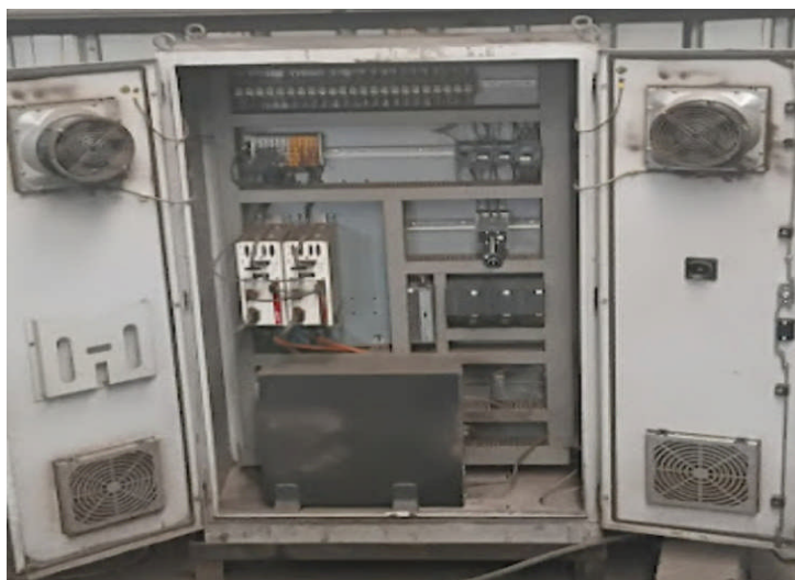
Figure □- 16: Armoire électrique
