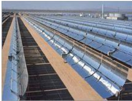
Figure I.4 : Centrale solaire thermodynamique
