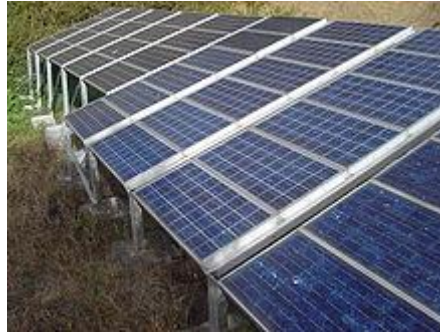
Figure I.8 : Centrale solaire photovoltaïque
