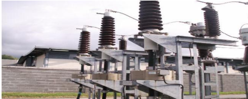
Figure-I-17- Une installation typique de parafoudre pour une remonté aéro-souterraine.
