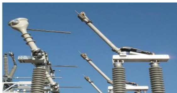
Figure (I-21) Cette figure nous montre un sectionneur de haute tension
