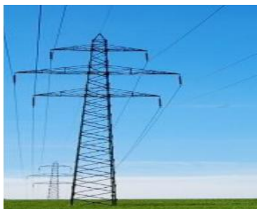
Figure(I-6) Ligne aérienne
