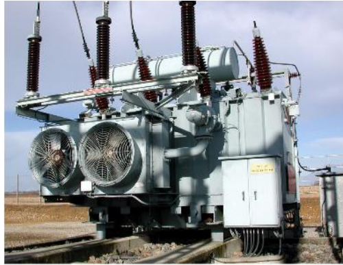
Figure (I-18) Cette figure nous montre un transformateur de puissance à refroidissement forcé
