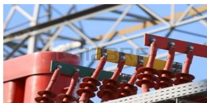
Figure (I-20) la figure suivant illustre un modèle de jeu de barre qui sert à connecter les conducteurs des phases
