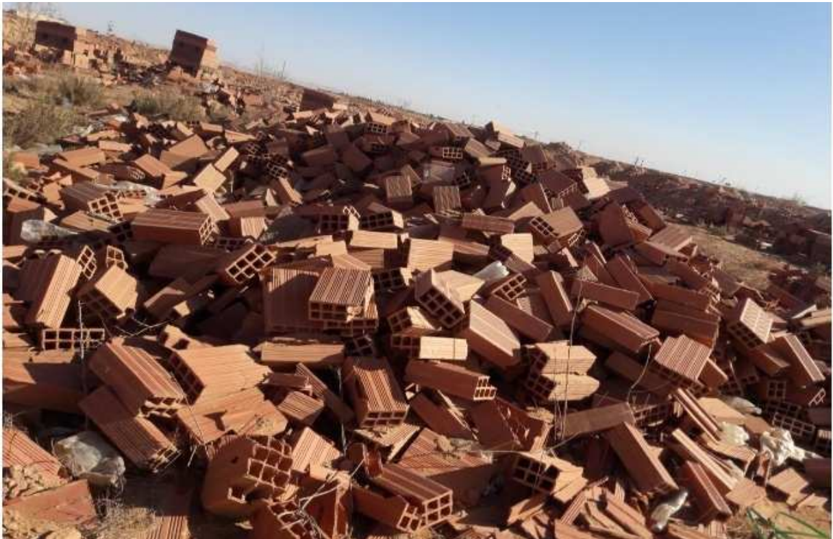
FigureII.4:Remblai de déchets de briques dans un chantier a Tizi-Ouzou.
