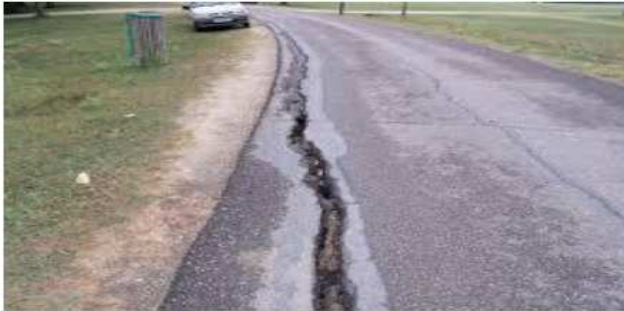
Figure I.10 : Fissures dans une chaussée.(LCPC,1998)
