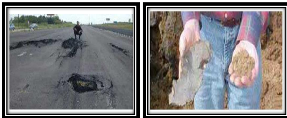
Figure 22.1 : Dégradation de Chaussées ( Jennings .1962 ).
