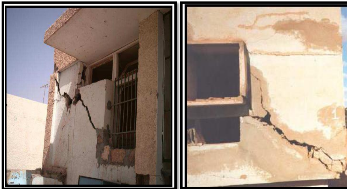
Figure 16.I : Fissure sur les murs et Fissures diagonales (Derriche Z et al.2002)
