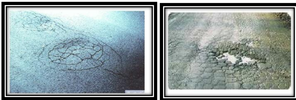
Figure 21.1 : Dégradation des routes ( Freeah 2006 ).
