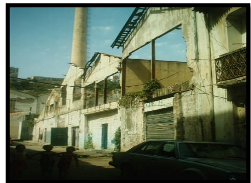
Figure 41 : bâti en mauvais état Source : photos prise par les auteurs le 30/01/2017
