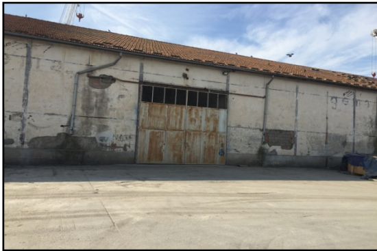
Figure 166 : Des hangars dégradés à l'intérieur de vieux port/Source : Prise par les auteurs
