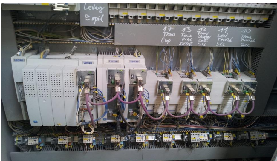
Figure I-24 : Exemple de variateur de vitesse à l'usine.
