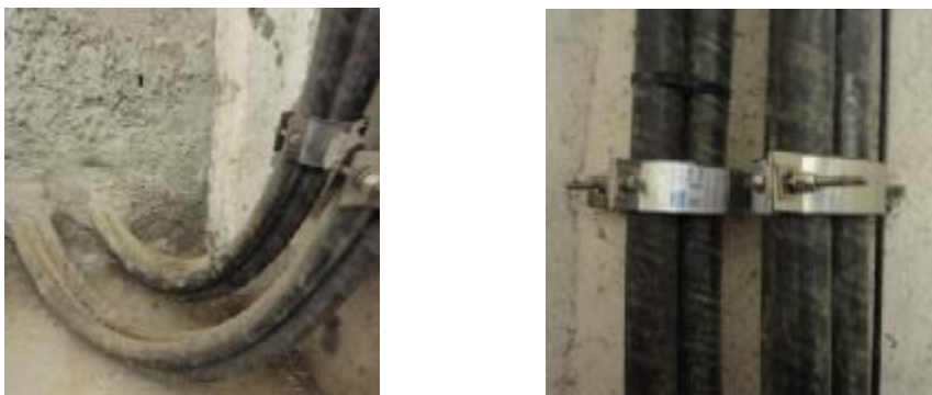
Figure 4-5- Arrivée des câbles dans la station (câble d'alimentation et de secours)
