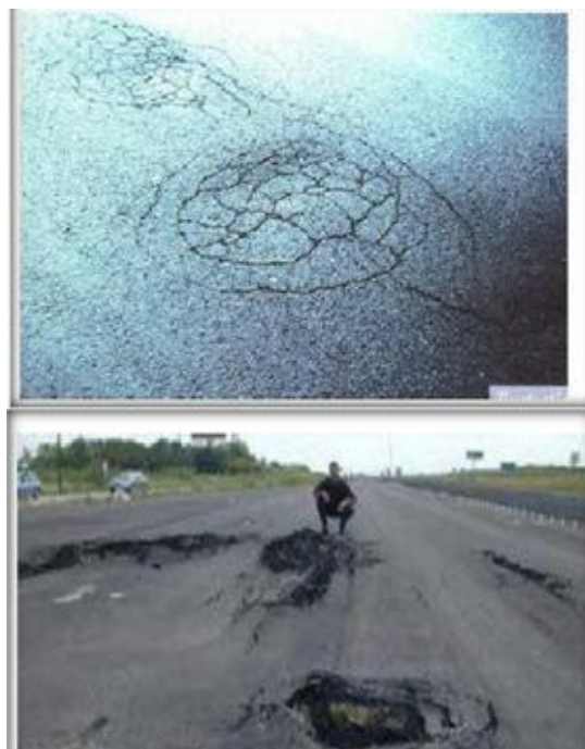
Figure II.4 : Dégradation des routes (Freeah, 2006).
