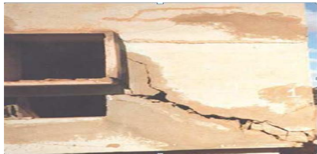
Figure II.1 : Fissure sur les murs et fissure diagonales (Derriche et al., 2002)
