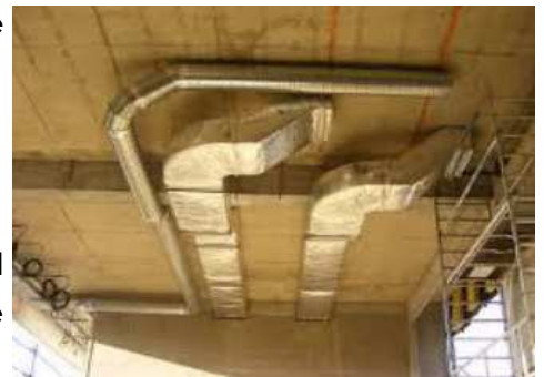
Figure 147: Exemple sur la climatisation ; source: www.google ima-
